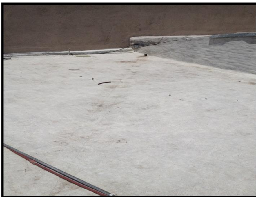
Fotografía 2.7 – Fisuras en la losa plana de la zona del ingreso.
