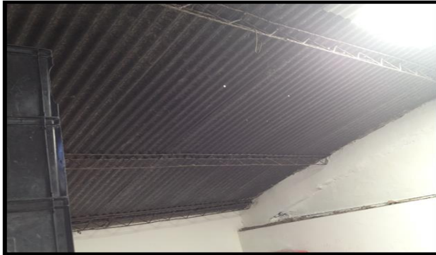
Fotografía 2.1 – Huecos en la chapa
