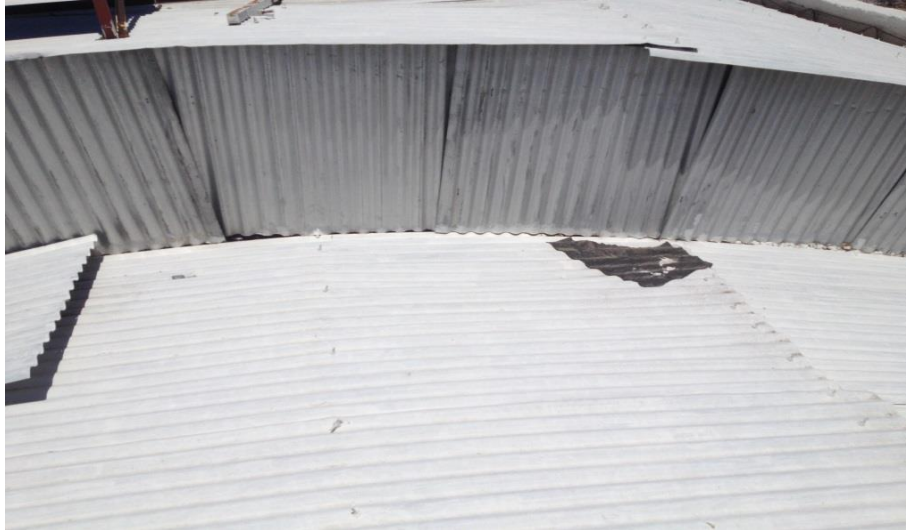
Fotografía 2.6 – Aberturas en uniones de techo de diferente altura.
