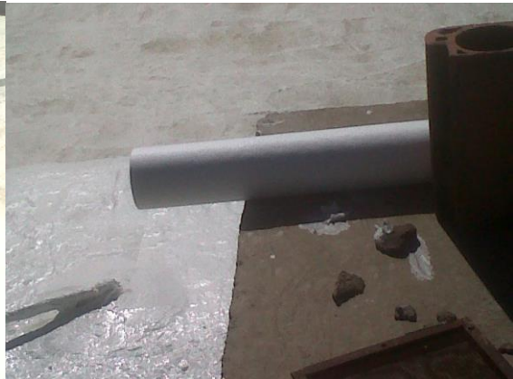
Aplicación de dos manos cruzadas de SIKAFILL con un intervalo de 24 hs
