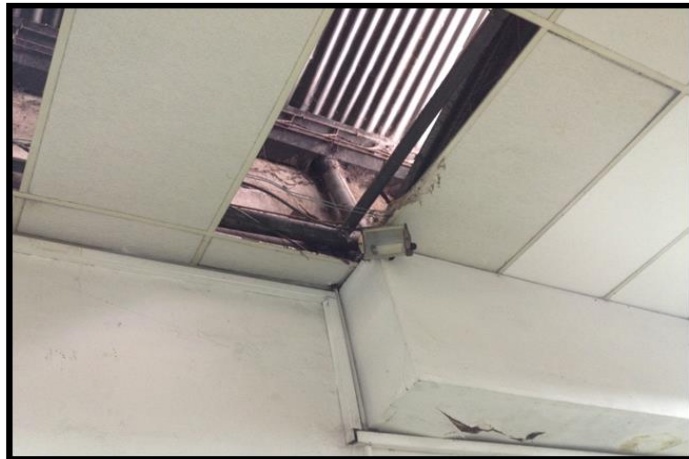
Fotografía 3.1 – Faltante de placas para cielorraso suspendido.
