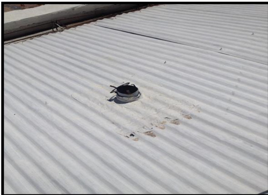
Figura 4.3 – Falta de sombrerete.
