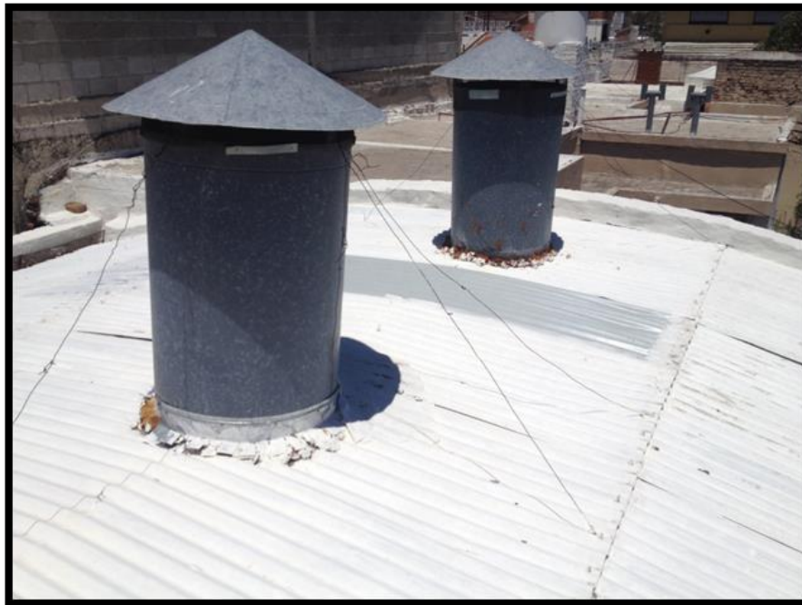
Figura 4.4 – Sombreretes de ventilación.
