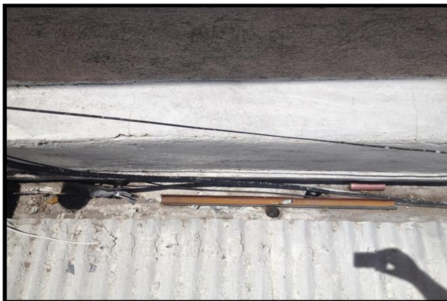
Fotografía 1.3 - Suciedad en canaleta.
