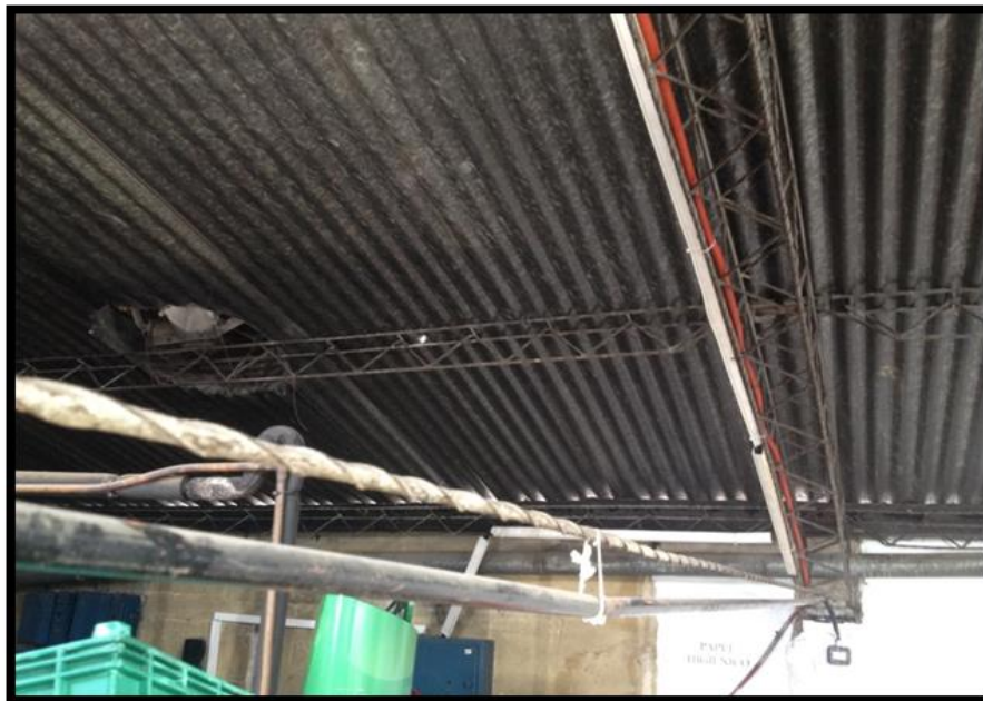
Fotografía 2.2 – Huecos en la chapa
