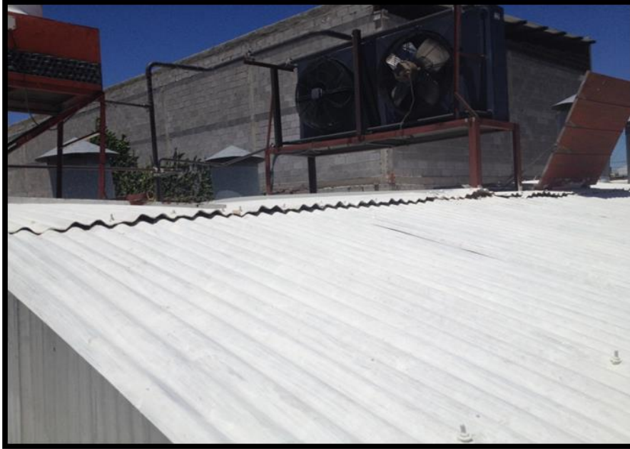
Fotografía 2.3 – Aberturas en las uniones entre chapas.
