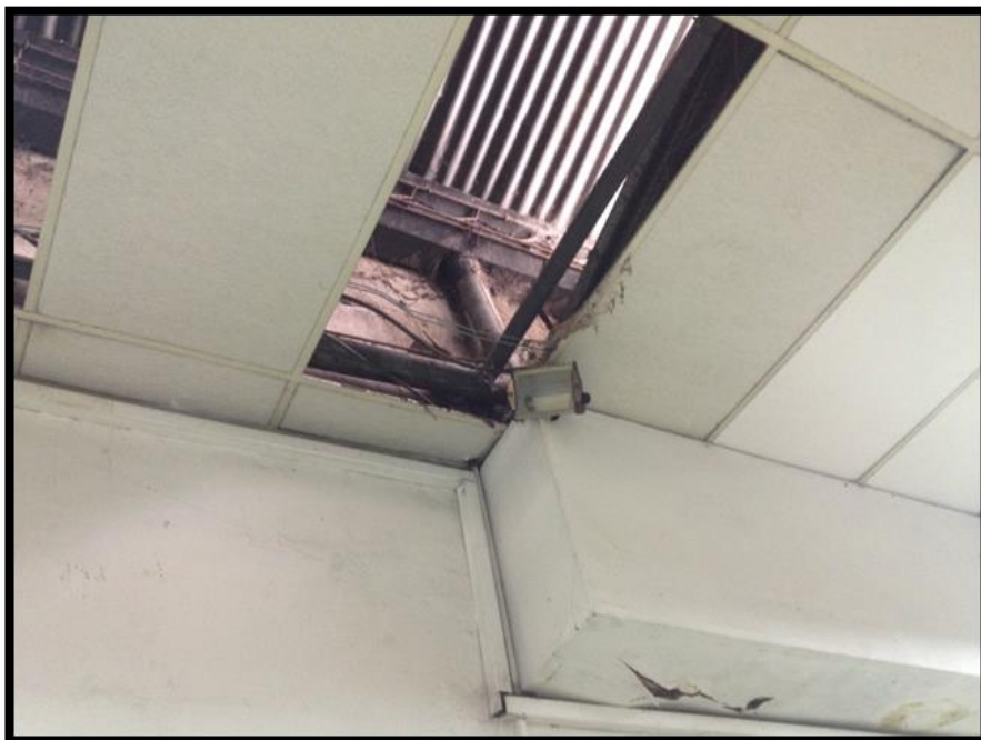
Fotografía 1.5 - Cañería existente de zinguería.
