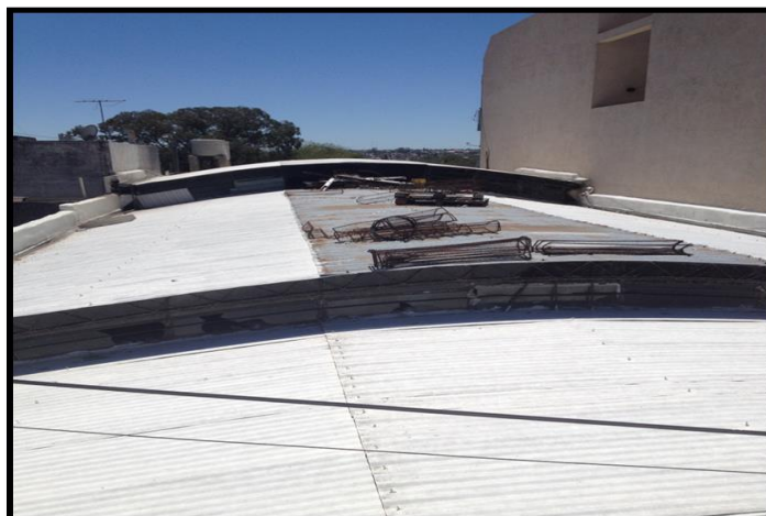
Figura 4.1 – Vidrios rotos en techo.
