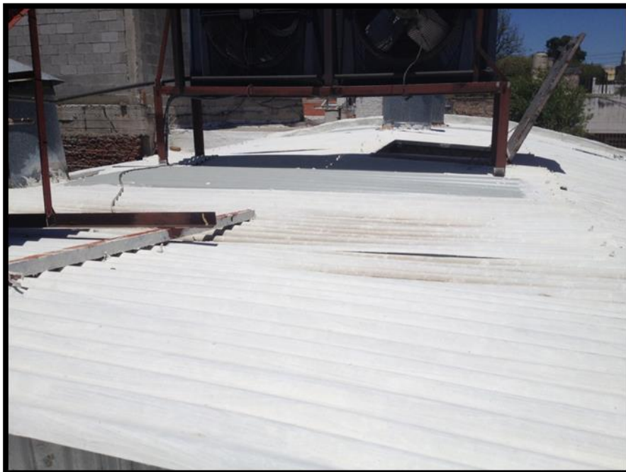
Fotografía 2.4 – Chapas deformadas y sin pendiente para escurrimiento de agua.
