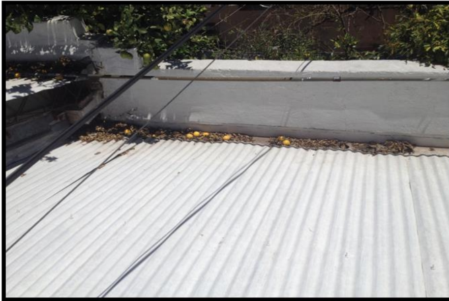
Fotografía 1.4 - Suciedad en canaleta.
