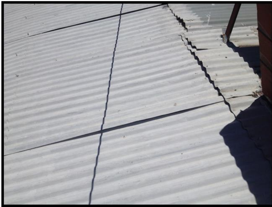
Fotografía 2.5 – Aberturas en las uniones entre chapas.
