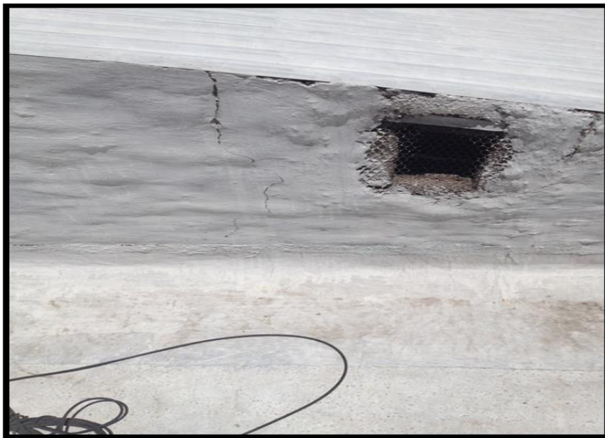
Figura 4.2 – Defectos varios en mampostería.
