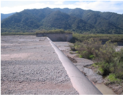
Figura 4: Tarquinamiento del dique fijo.
