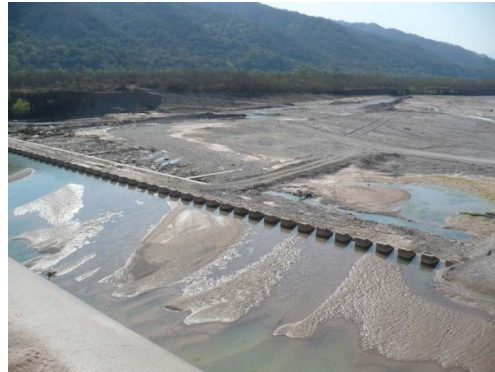
Figura 5: Erosión generalizada en el lecho del río.
