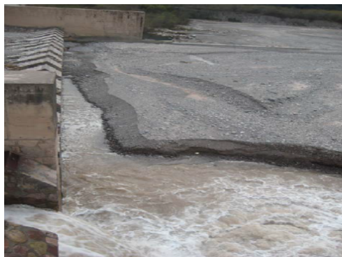
Figura 8: Erosión localizada al pie del canal moderador.
