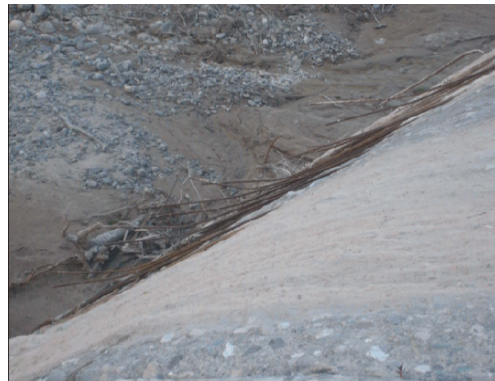
Figura 7: Abrasión del dique fijo.
