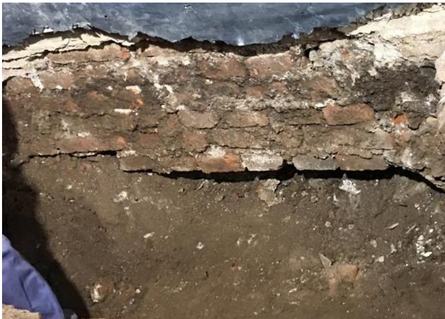
Figura 3.72. Excavación en Iglesia. Deslizamiento de suelos
