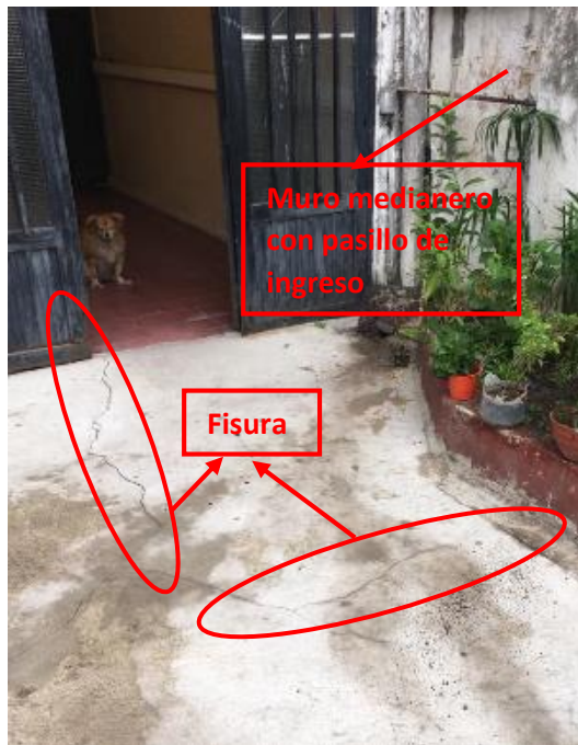
Figura 3.32. Fisuras piso de Artime
