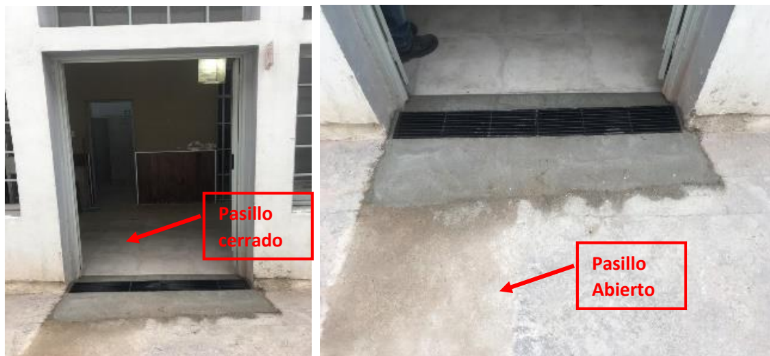
Figura 3.97. Rejilla en pasillo abierto
