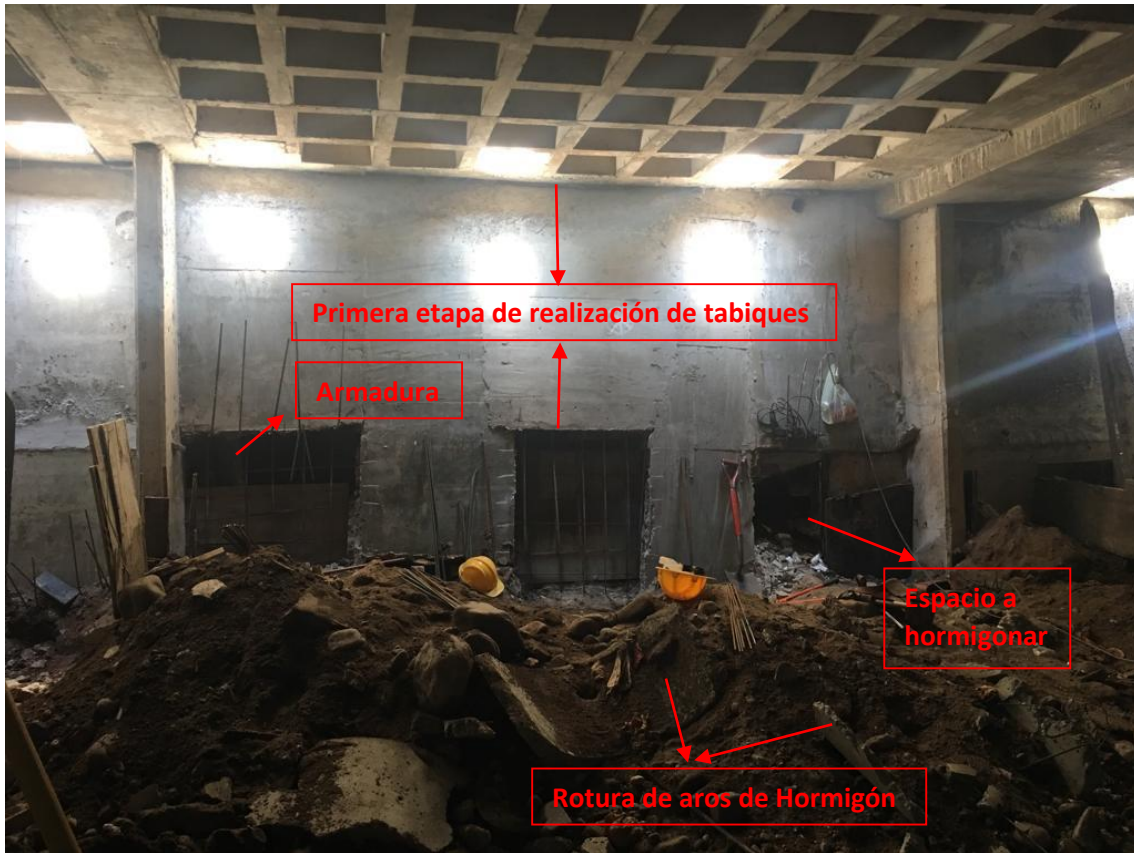
Figura 3.60. Rotura de aros de hormigón. Hormigonado espacios vacíos
