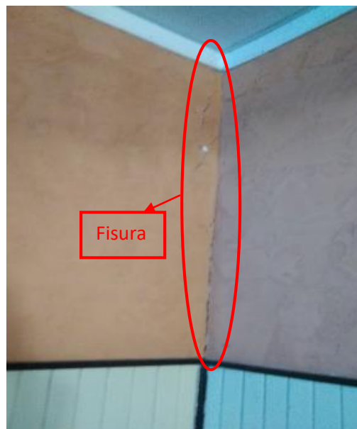
Figura 3.22. Fisura encuentro de muros iglesia
