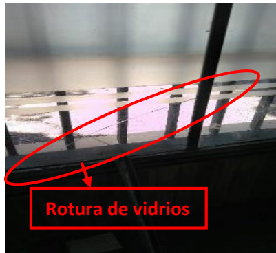
Figura 3.31. Rotura de vidrios
