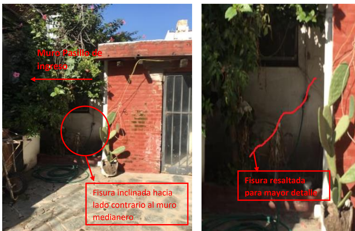
Figura 3.37. Daños preexistentes Vivienda Artime
