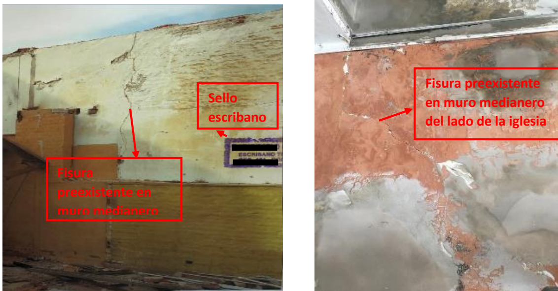
Figura 3.35. Fisura en muro medianero entre Iglesia y edificio LOBOS IV
