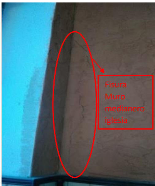
Figura 3.23. Fisura muro medianero
