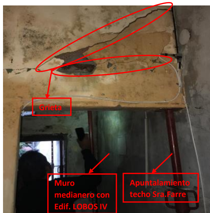
Figura 3.34. Grietas en vivienda Farre
