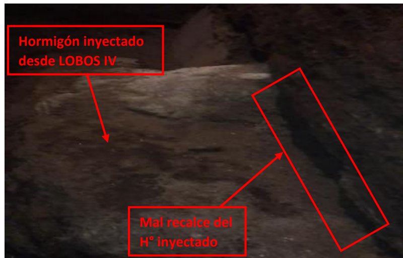
Figura 3.106. Hormigón inyectado. Mal recalce
