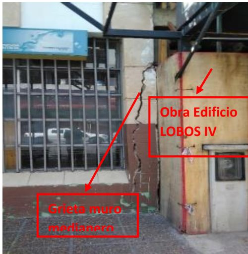
Figura 3.25. Grieta muro medianero desde el exterior
