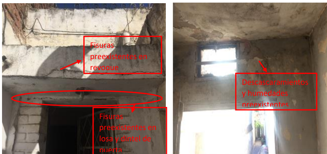
Figura 3.36. Ingreso a vivienda de la Sra. Mirta Farre .Daños preexistentes a inicio de obra LOBOS IV
