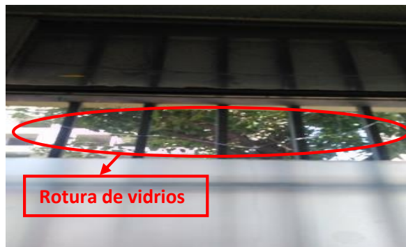
Figura 3.30. Rotura de vidrios
