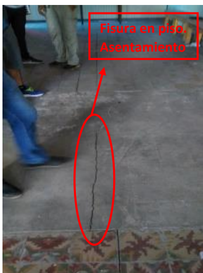
Figura 3.29. Fisura en piso
