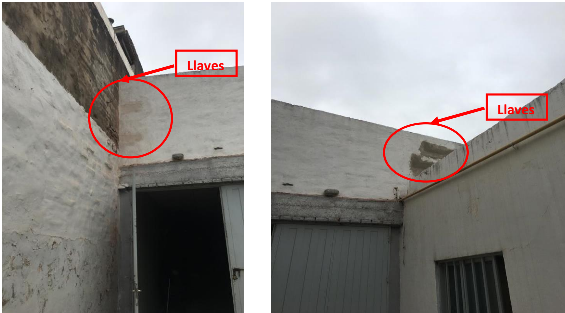
Figura 3.99. Llaves en fisuras
