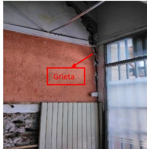
Figura 3.24. Grieta muro desde interior
