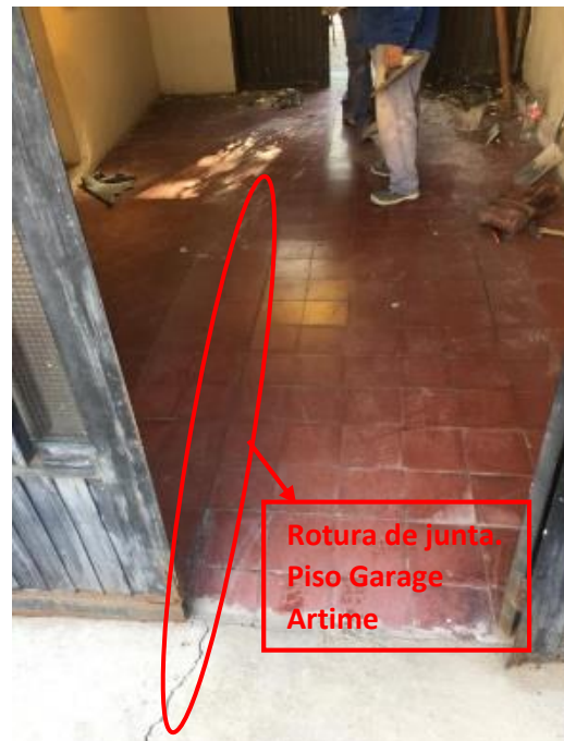
Figura 3.33. Rotura junta de piso Garage Artime
