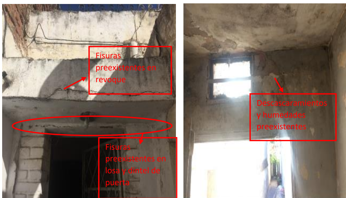
Figura 3.113. Situación previa a reparar
