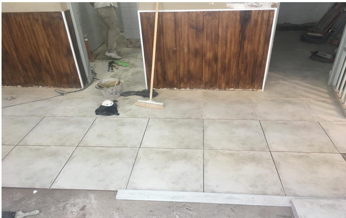
Figura 3.98. Solados en pasillo
