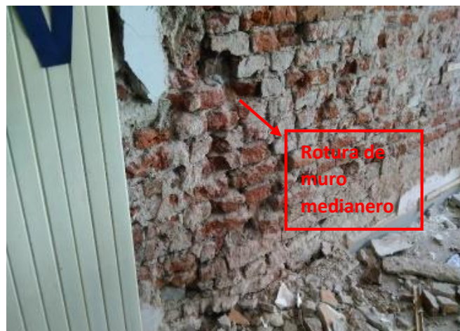
Figura 3.27. Rotura muro medianero
