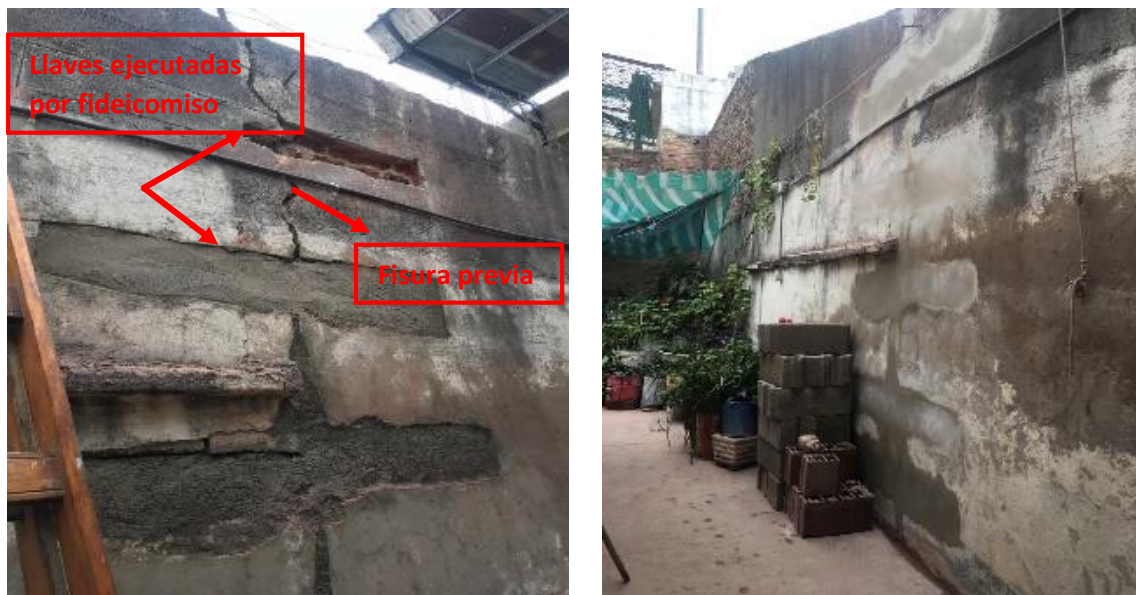
Figura 3.43. Daños preexistentes con sus reparaciones en Artime
