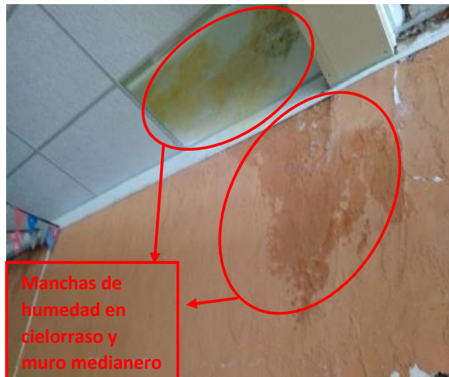
Figura 3.28. Manchas de humedad iglesia
