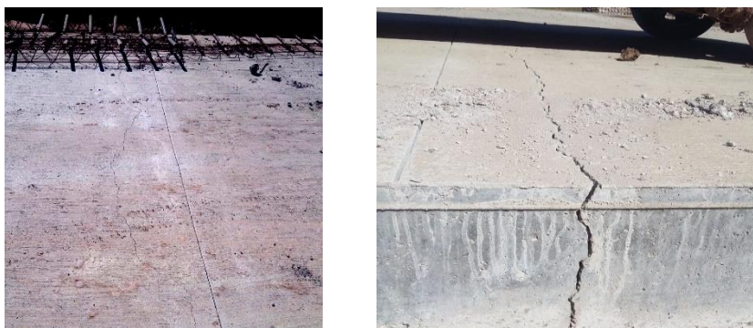
Figura 15: Fisuración de calzadas de hormigón por aserrado tardío.
