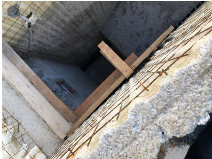
Figura N° 35 - Panel fuera de plomo.
