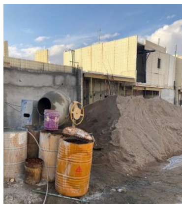
Figura N° 41 - Espacio de mezclado.
