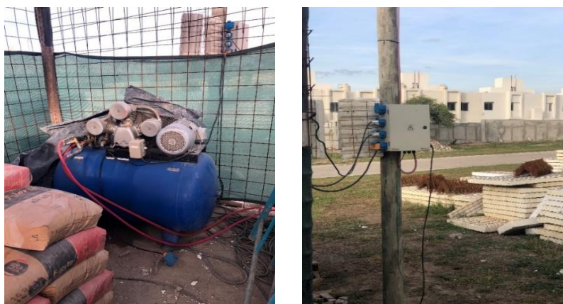
Figura N° 19 - Compresor de aire y conexión eléctrica.
