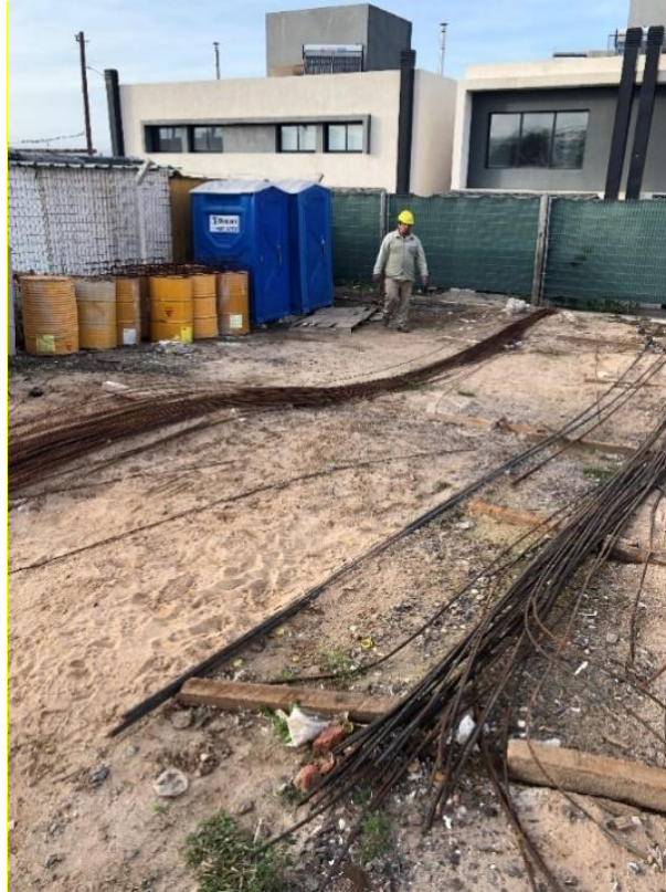
3 - Almacenaje de barras de acero, aditivos y disposición de baños para trabajadores.
