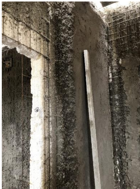
Figura N° 42 - Muro cargado en exceso.
