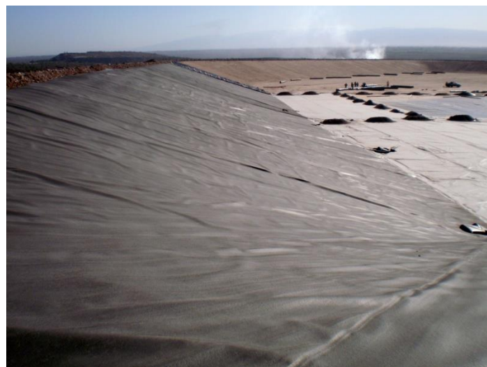
Imagen 4.28. Membrana del relleno sanitario.
