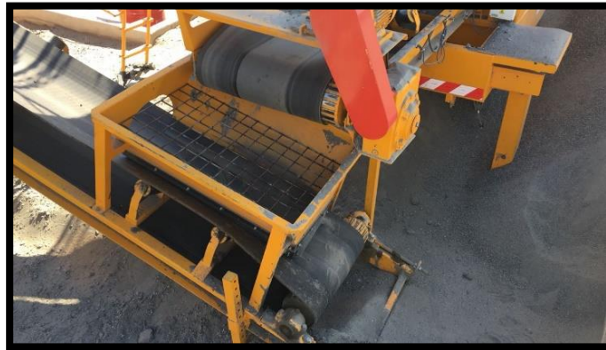
Imagen 3.1- Caída de cinta transportadora de tolvas
