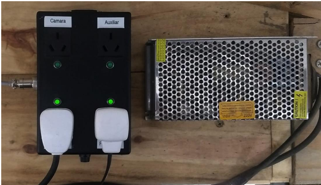
Figura 57: Power Switch (Fuente: Propia)
