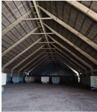
Figura 5: Celda de almacenamiento
