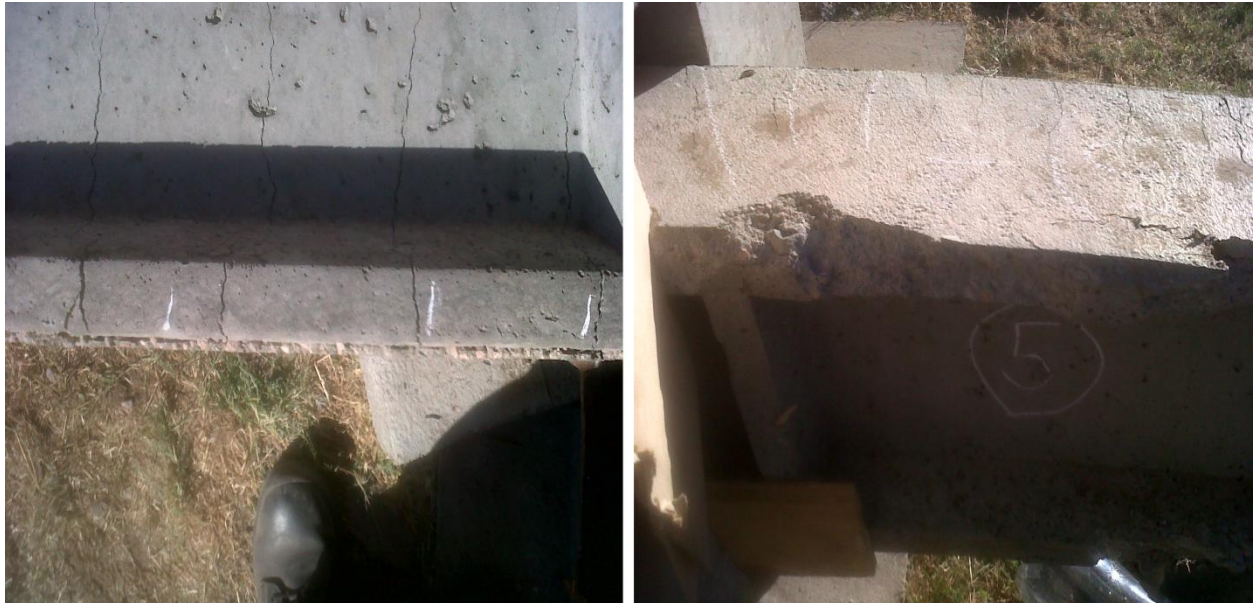
Figura 5.7 a Inspección ocular de las fisuras.
