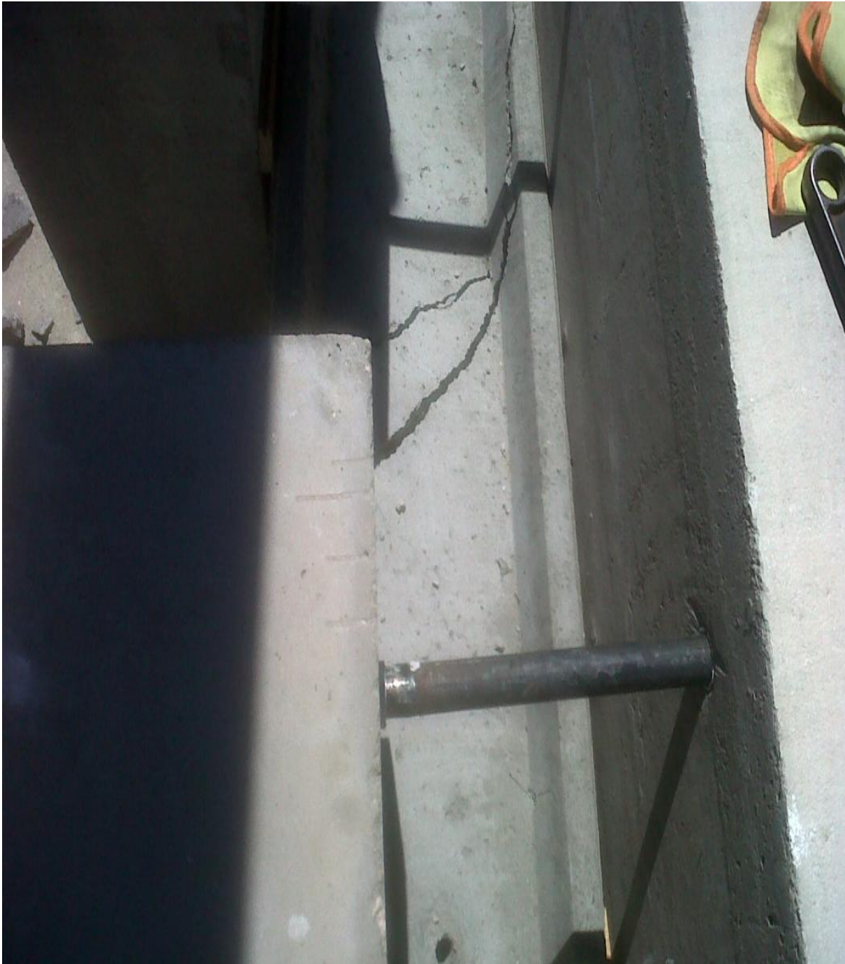
Figura 5.4 Fisura en el tamo de empotramiento.
