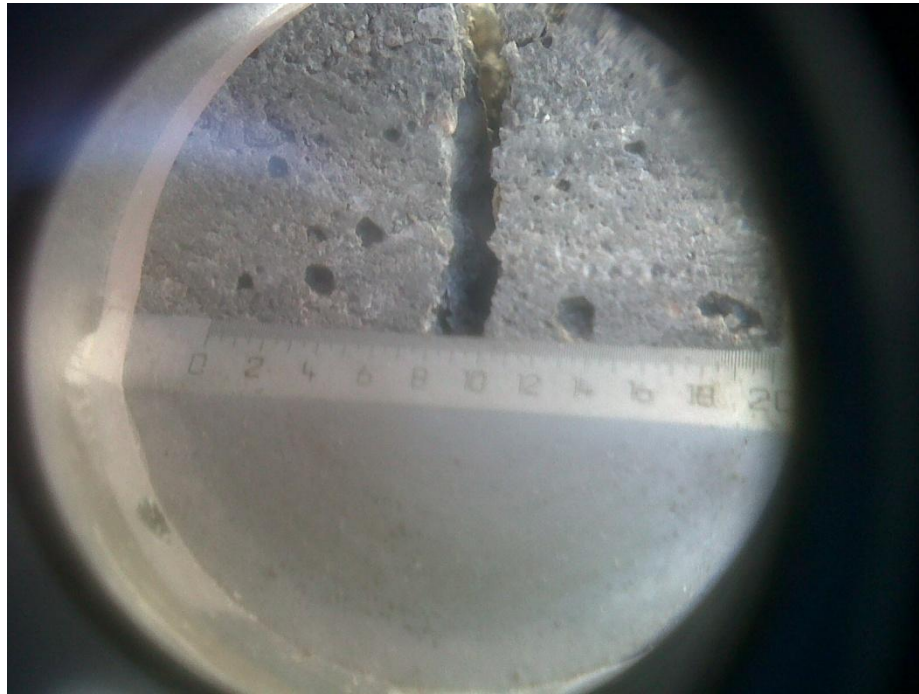
Figura 5.7 c Inspección ocular de las fisuras con instrumental (fisuras del orden de 2 milímetros).
