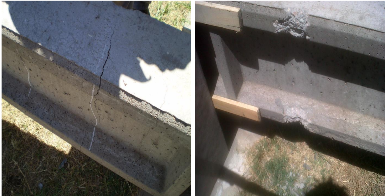
Figura 5.9 Fisuras en la zona traccionada y desprendimiento del hormigón de recubrimiento en la zona comprimida.
