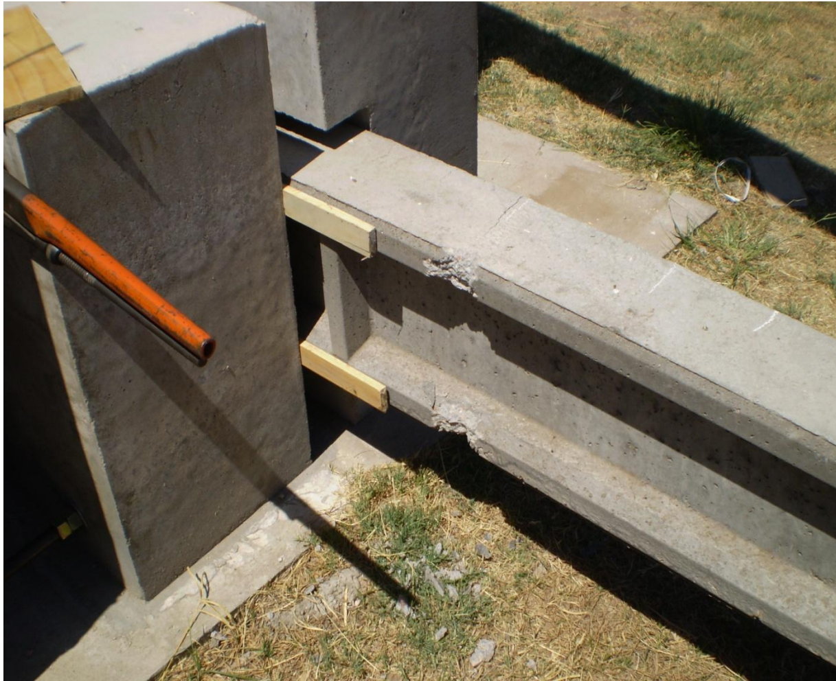
Figura 5.8 Deformación permanente en la base de empotramiento.
