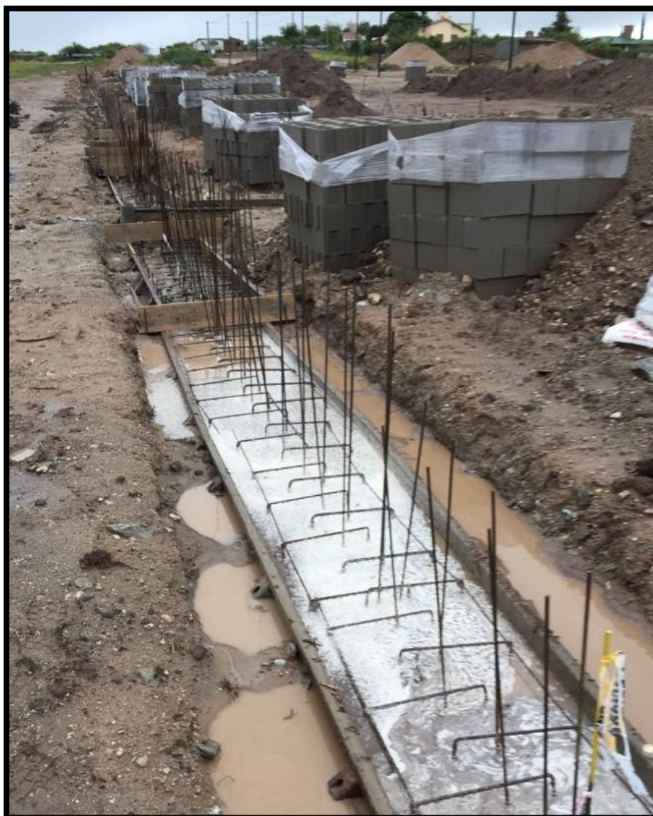
Figura 65. Daño producido por la lluvia previo al hormigonado.
