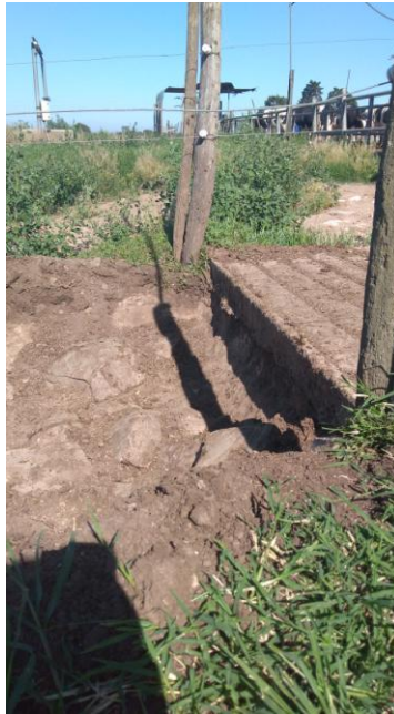
Figura 4: Detalle del desnivel del suelo a la salida de la sala de ordeño.
