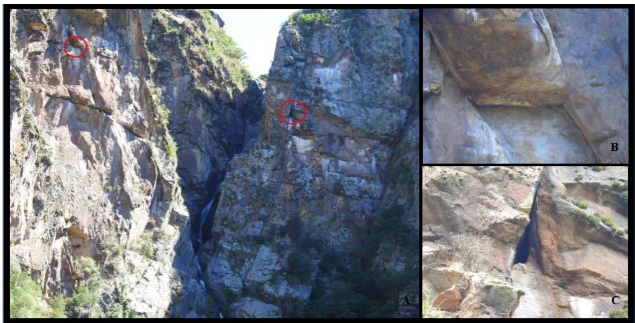
Figura 3. Grietas utilizadas por A. andecolus . A) Paredes en las que se ubican las grietas; B) y C) Grietas utilizadas. Las fotos corresponden al sitio “Cascada de Los Chorrillos”.
