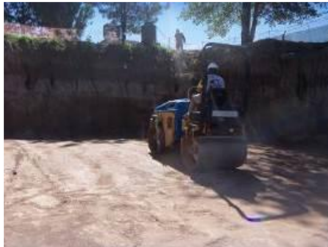
Figura 4.1.34: Compactado de sedimentador
