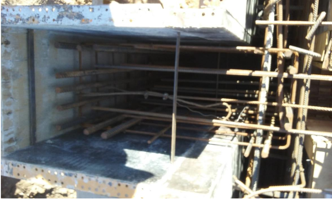
Figura 4.1.49: Separación excesiva de armaduras
