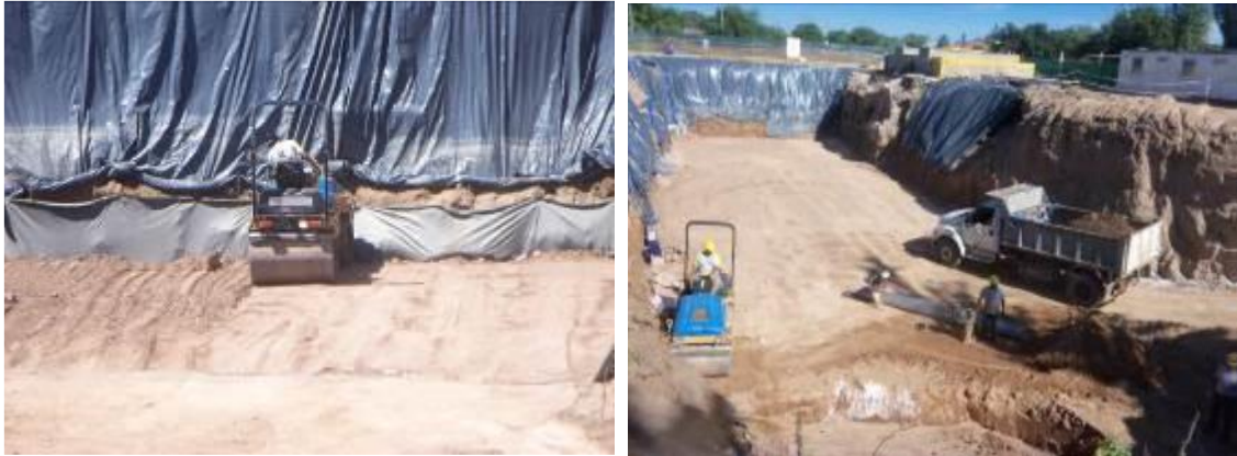
Figura 4.1.33: Compactación en B.A.-MBBR-D
