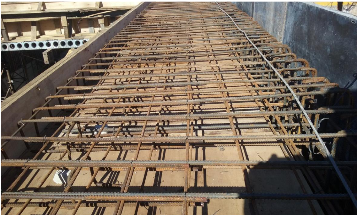
Figura 4.1.50: Separación excesiva de armaduras
