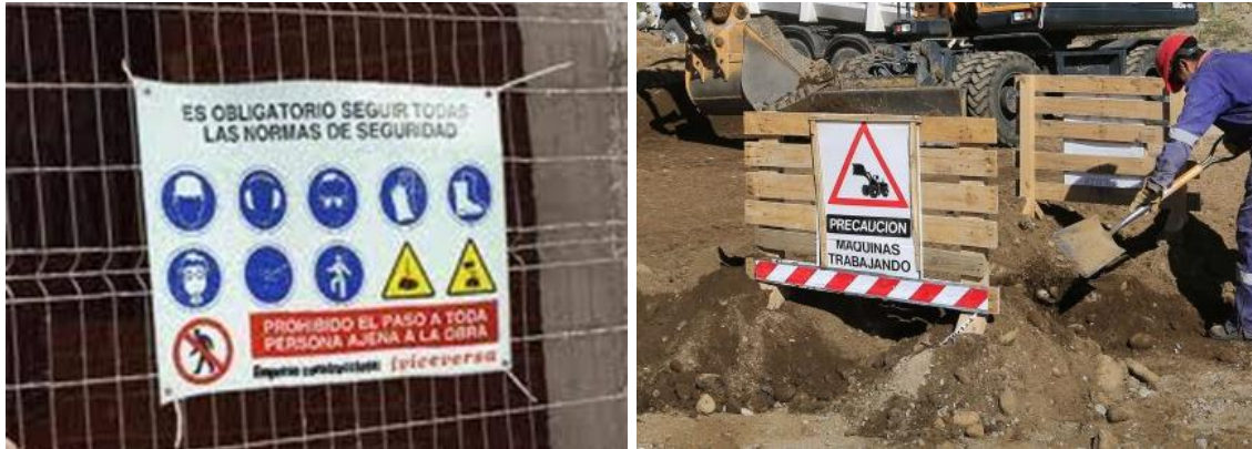
Figura 4.1.10: Colocación de señales visibles de precaución
