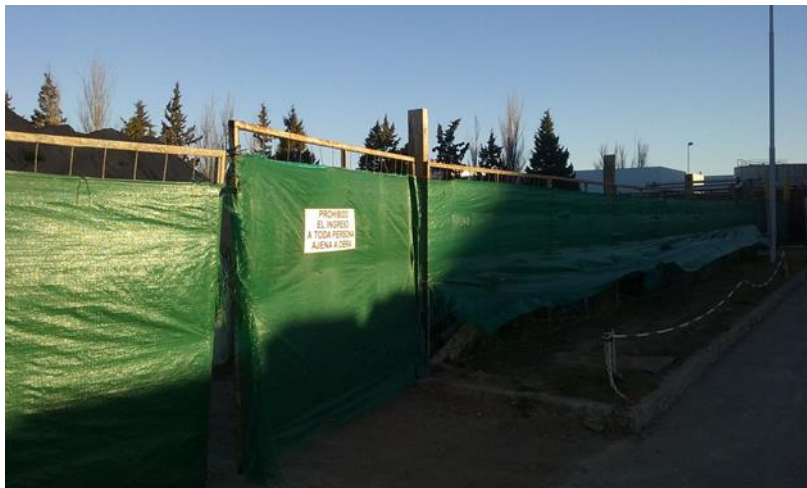
Figura 4.1.9: Cerco de sector oeste en mal estado de conservación
