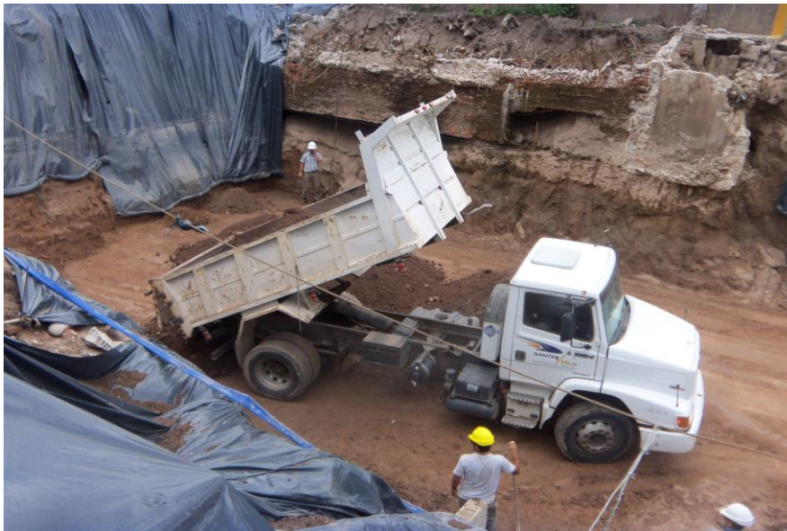
Figura 4.1.29: En Cámara B.A.-MBBR-D. relleno con destape granular
