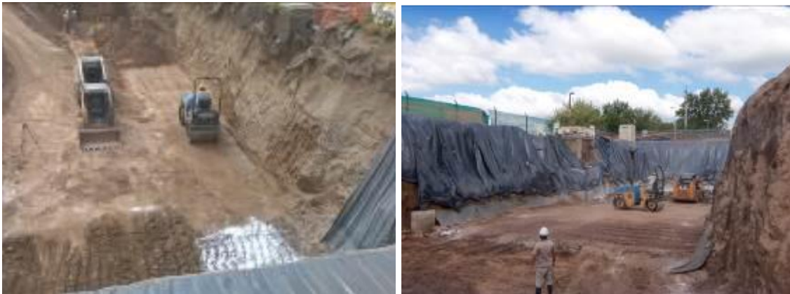
Figura 4.1.32: Compactación en B.A.-MBBR-D
