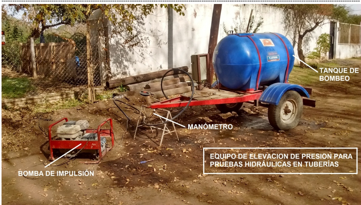
FIGURA N°45: FOTO DE SISTEMA PARA ELEVAR LA CARGA DE CAÑERÍA EN PRUEBA HIDRÁULICA.
