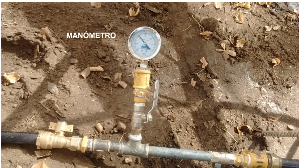
FIGURA N°46: FOTO DE MANÓMETRO PARA TOMAR LECTURA DE LA CARGA DE CAÑERÍA EN PRUEBA HIDRÁULICA.
