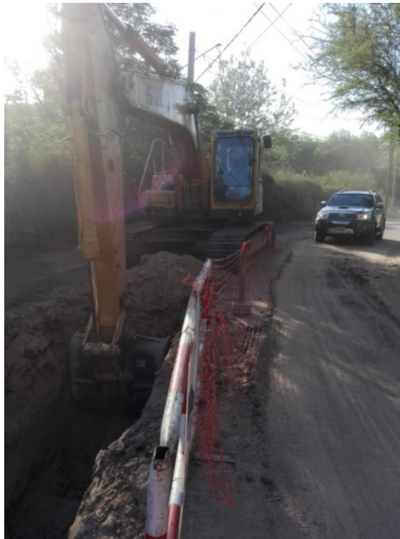
FIGURA N°28: INTERFERENCIAS EN VÍA PÚBLICA.
