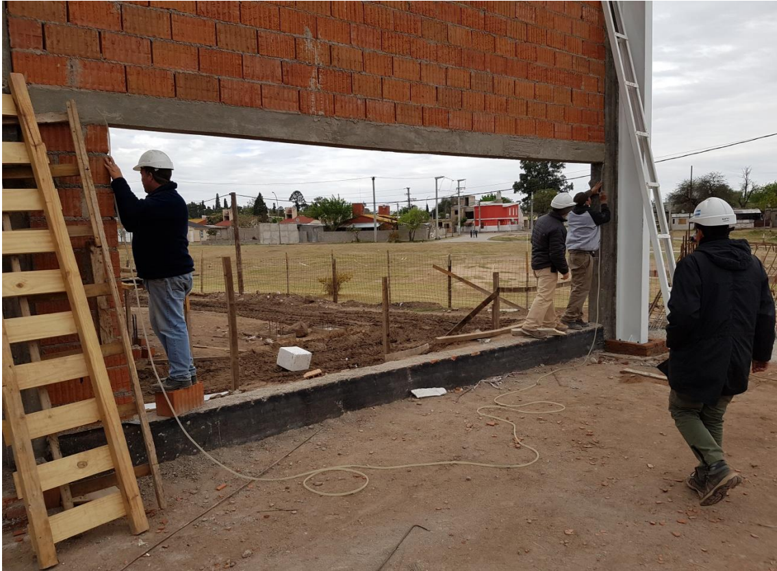
Fig.66 Medición de la flecha de la viga del SUM en parque este
