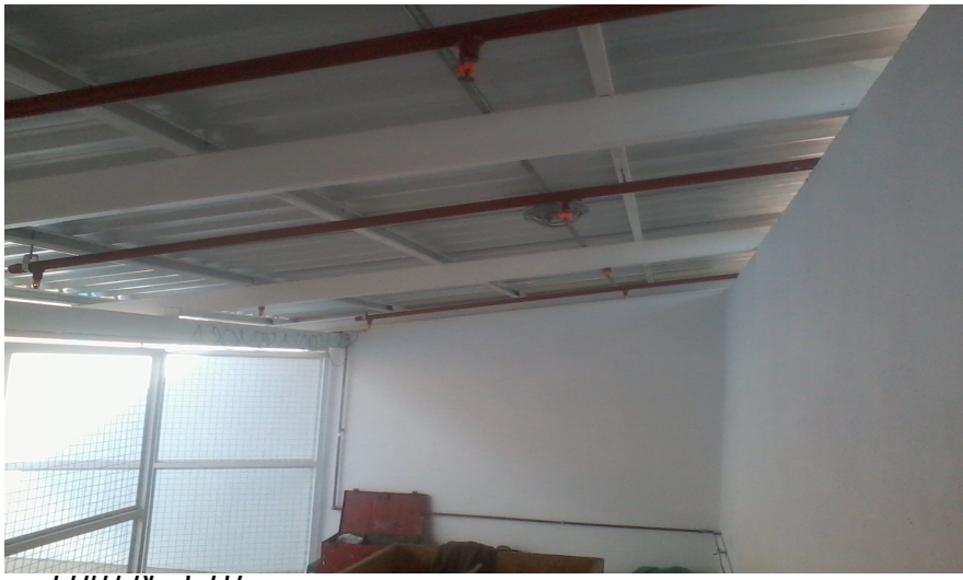
Velas con Rociadores dentro del Depósito de Acetileno
