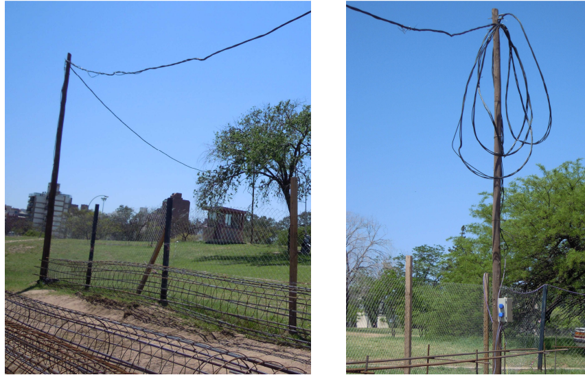
Fig. 3.4 y Fig. 3.5 Tendido eléctrico – Fuente: Fotografía propia
