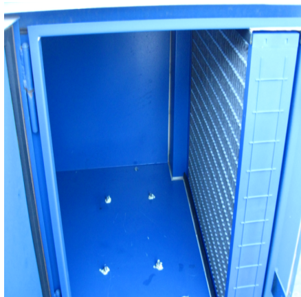
Figura 3.87.a: Filtro de aire equipo Quirófano
