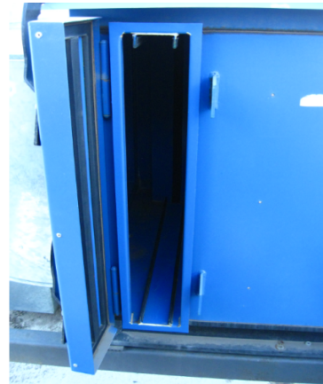
Figura 3.87.b: Filtro de aire equipo Quirófano
