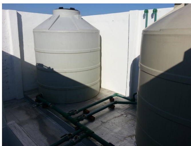
Figura 14: Tanques de azotea
