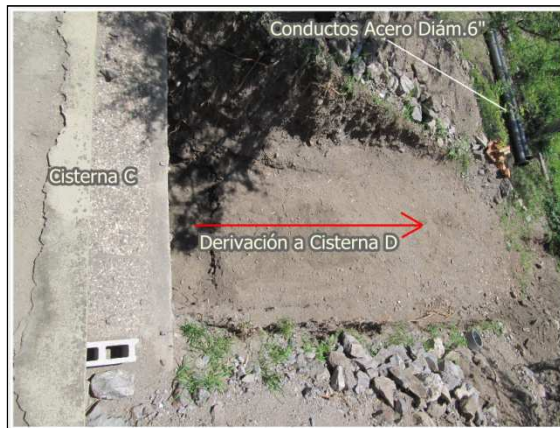
Foto 8: Vinculación Cisterna C y E
