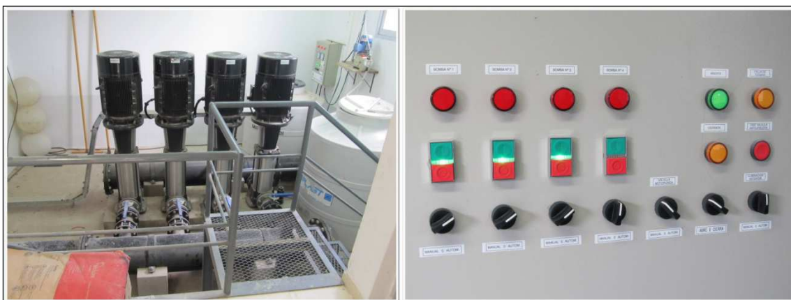
Foto 11: Equipo de Bombeo Cisterna Malvinas
