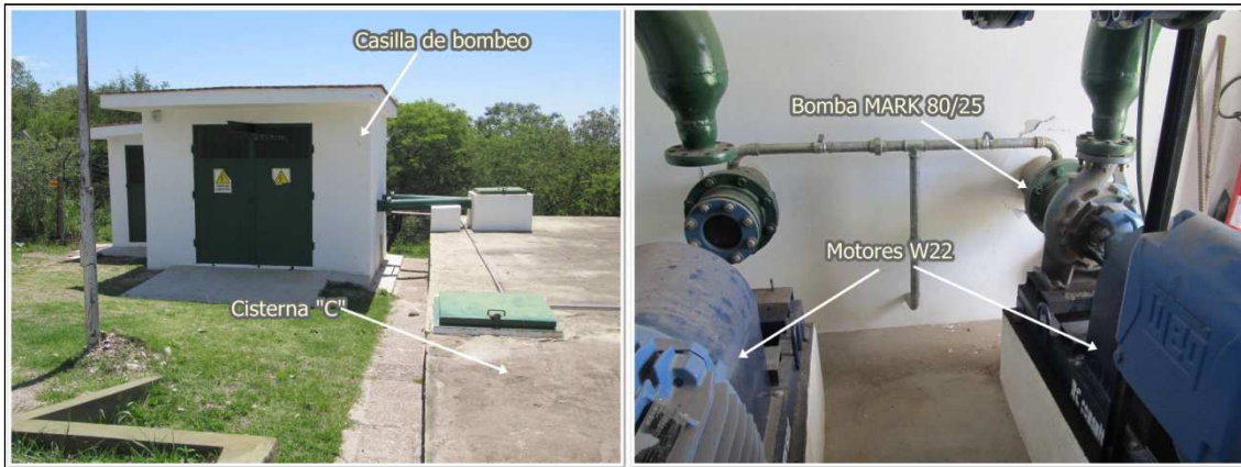
Foto 13: Bombeo Cisterna “C”
