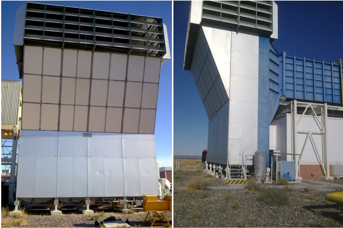
Figura 5. Torre de enfriamiento. Cara frontal y lateral derecho
