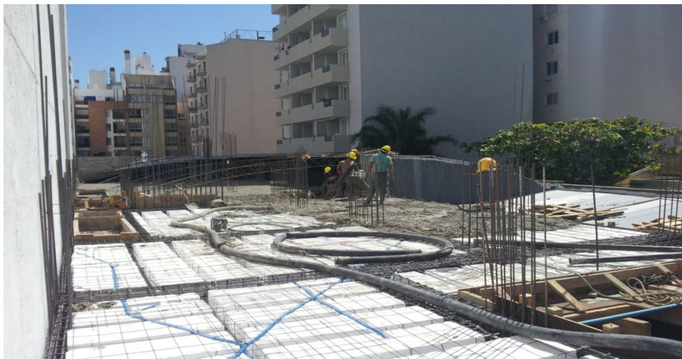
Aquí se observa como quedan expuesto las losas ante de hormigonar a siniestro de incendio
