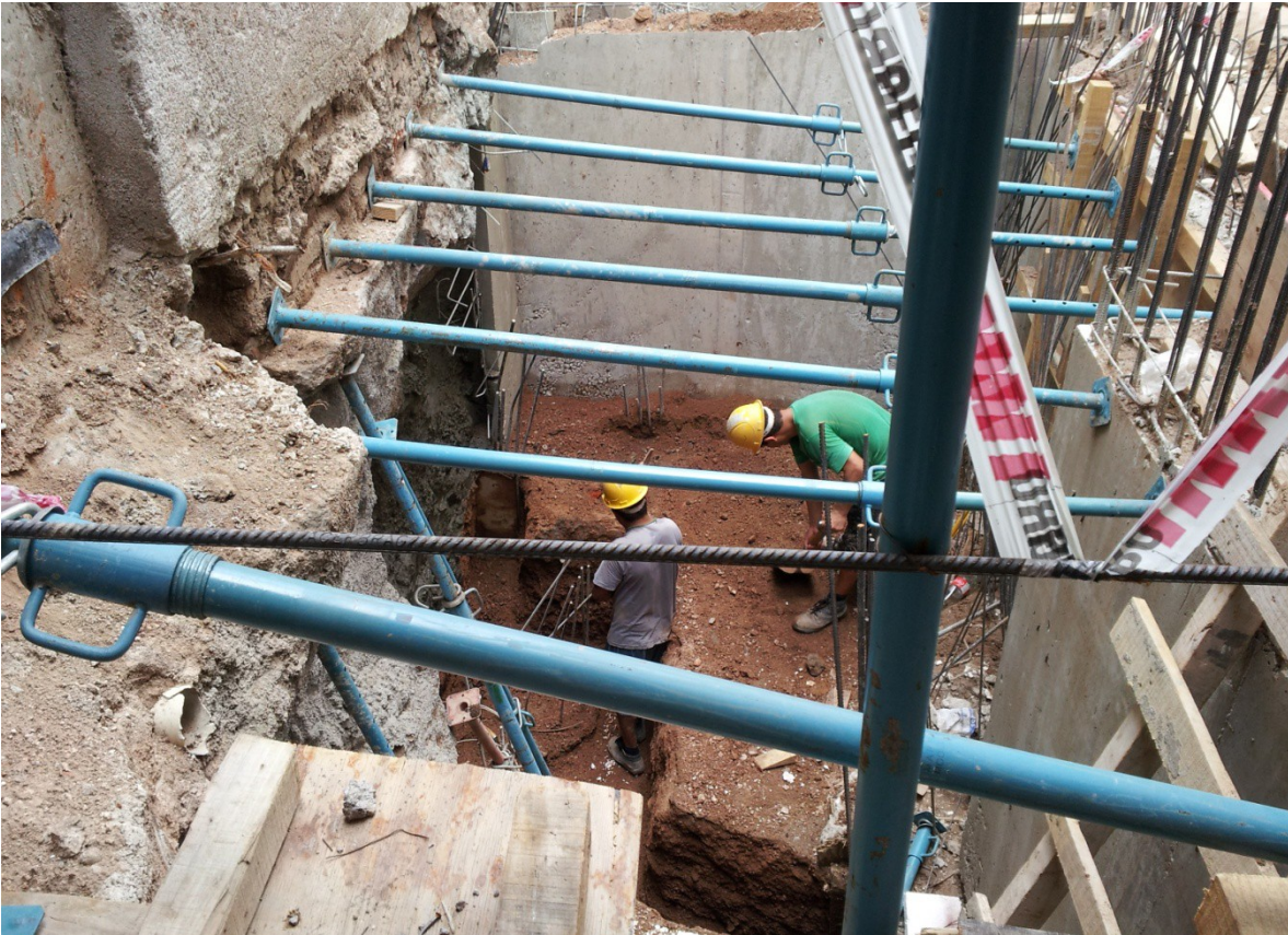
Imagen en donde se muestra como se apuntalo la excavación del subsuelo
