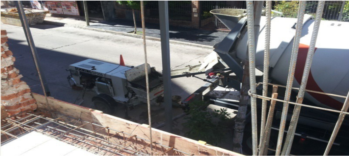
En esta imagen se observa los equipos para hormigonar , reservando estacionamiento media calzada
