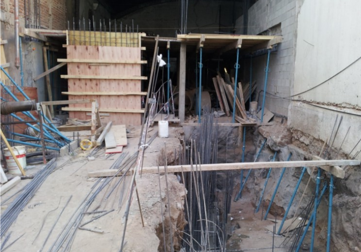
En esta imagen se observa como quedo partida la estructura por la presencia del subsuelo
