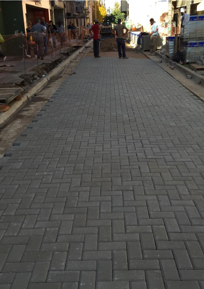
Foto ilustrativa: producto de medio día de trabajo por parte de la cuadrilla contratada.
