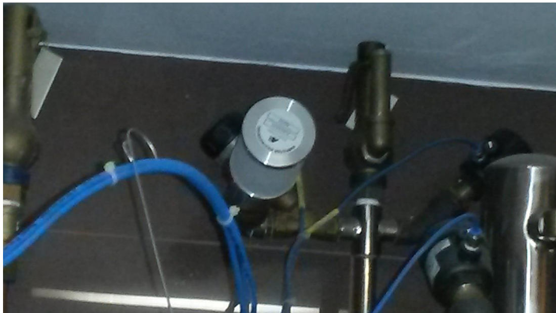
Ilustración 9.1.12 Fotografía del filtro de aireación de cámara.
