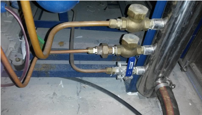
Ilustración 9.1.6 Fotografías de la ubicación placa orificio situada entre la unión doble.
