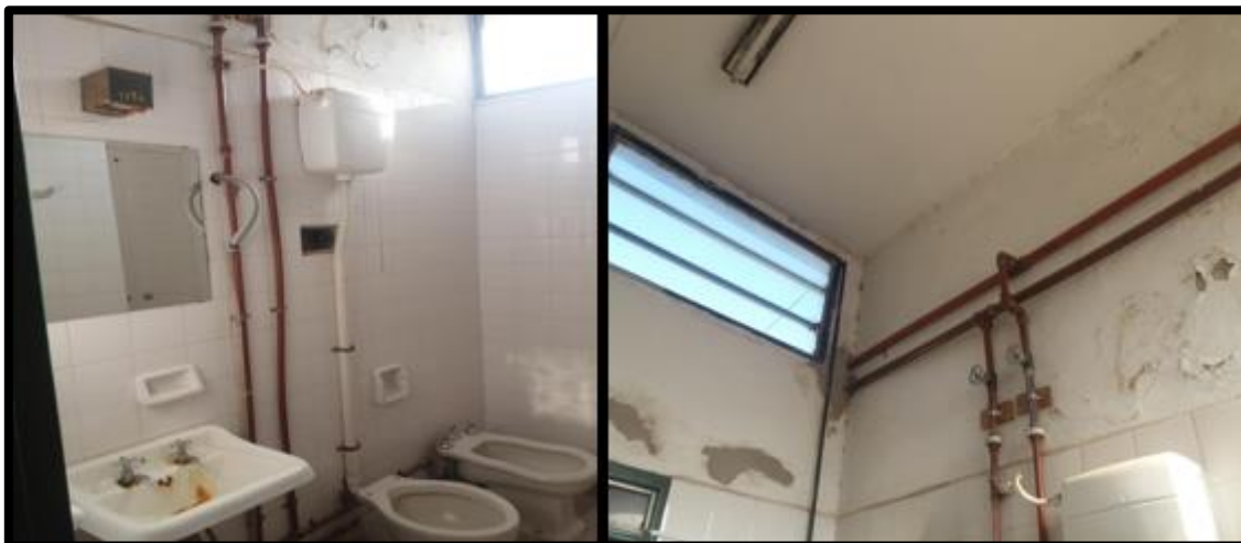
Figura 5.9 - Estado de los Baños.
