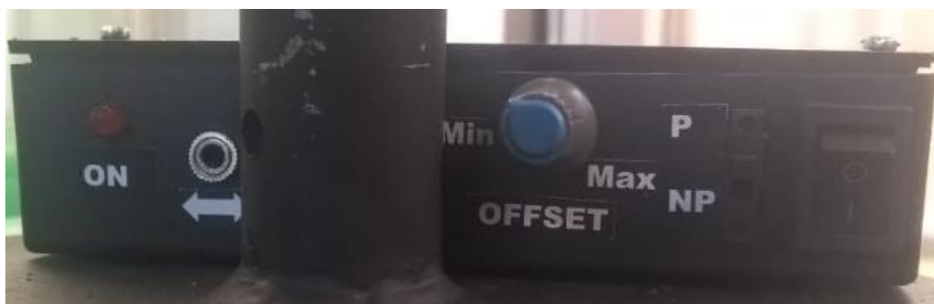
Ilustración 76: Vista frontal del control, con P se indica modo proporcional, y con NP el modo no proporcional.
