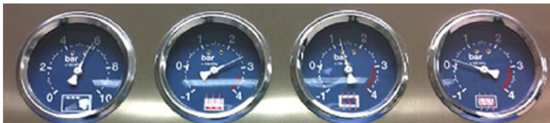
Ilustración 4: Manómetros que registran la presión del aire comprimido, generador de vapor, camisa y cámara
