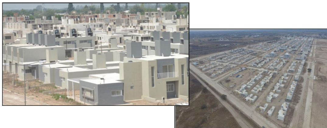
Imagen 15. Construcción de viviendas, ProCreaAr Fuente: Ministerio del Interior, Obras Públicas y Vivienda
