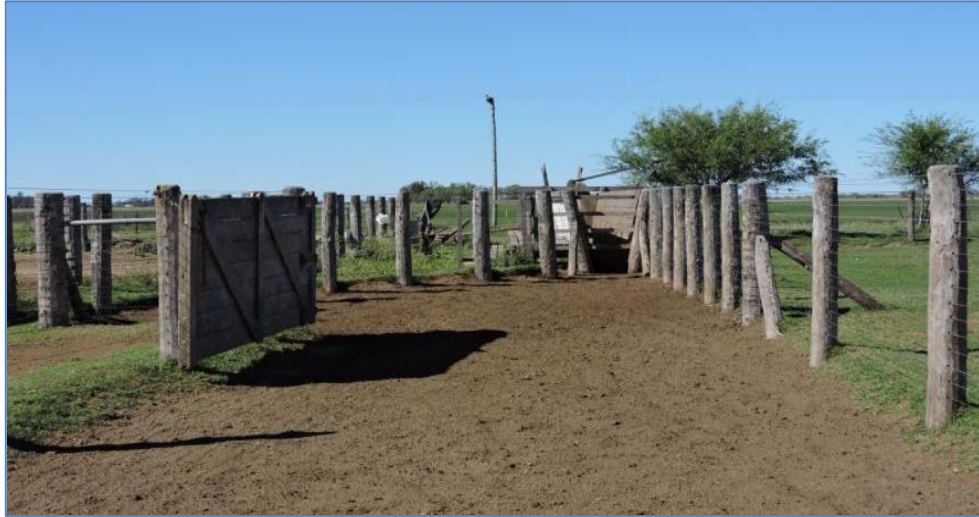
Ilustración 67: Ingreso al toril en buenas condiciones de piso y puertas pero con faltante de contención de madera ciega para el arreo de los animales.
