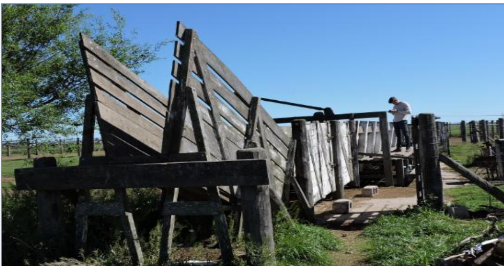
Ilustración 72: Cargadero en buen estado de conservación y con pendiente adecuada.
