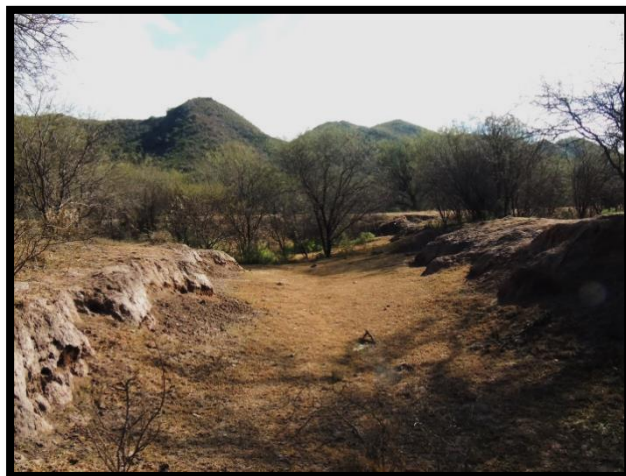
Fig. 22: Erosión en la salida de una alcantarilla de la ruta. (Foto: Moisés Fara)
