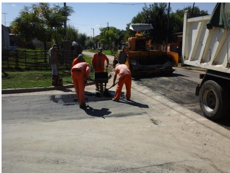
Figura N° 71: Defecto en tramo. (Fuente: Elaboración Propia)
