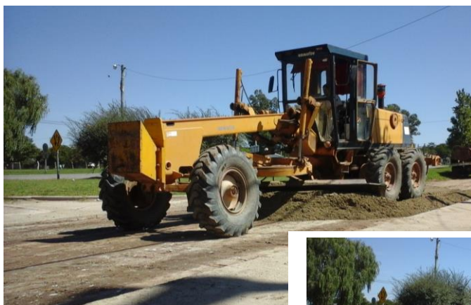
Fig 3.20 – Extensión de 0-20 en calle.
