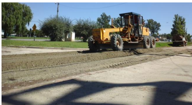
Fig 3.20 – Extensión de 0-20 en calle.
