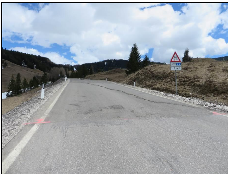
Figura 2: Sector de la ruta estatal S244, afectada por las deformaciones de terreno (Relevamiento propio).
