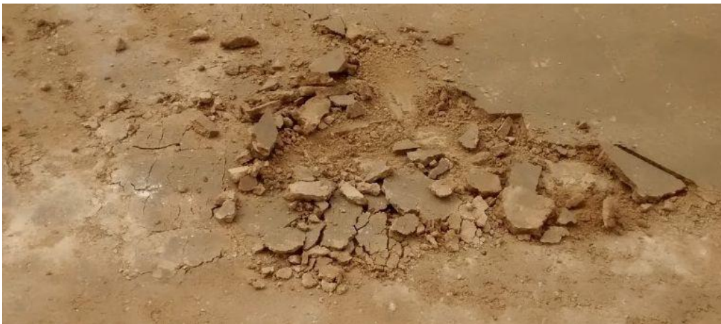
5.6 Solapamiento en la Subrasante
