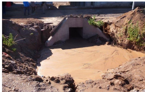
5.36 cuenco dissipador y parte de la sección de la alcantarilla colmatados
