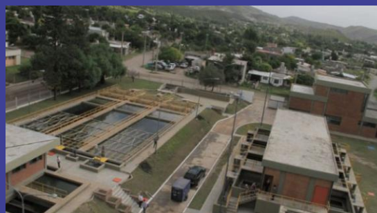
Figura 7.1.29- Planta potabilizadora de agua La Calera.
