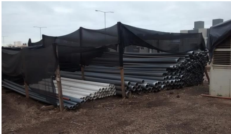
Figura 4.5 - Depósito de caños de menor DN.
