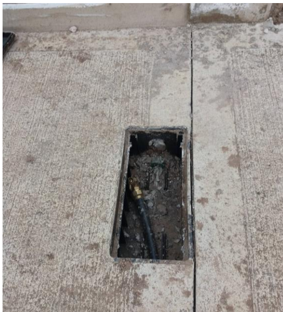
Figura 7.2 - Caja de medidores afectadas por el movimiento de suelo.
