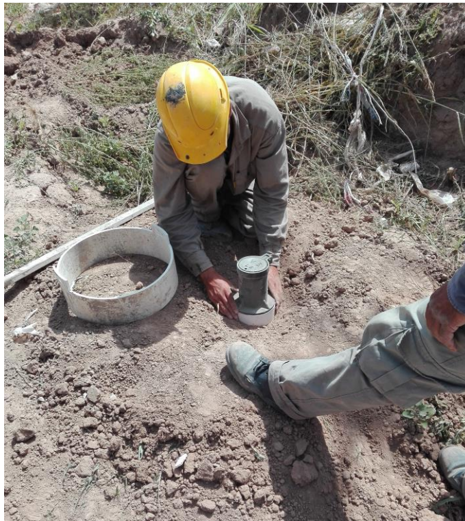
Figura 5.14 - Colocación del brasero sobre caño campana a nivel para posterior hormigonado de losa.
