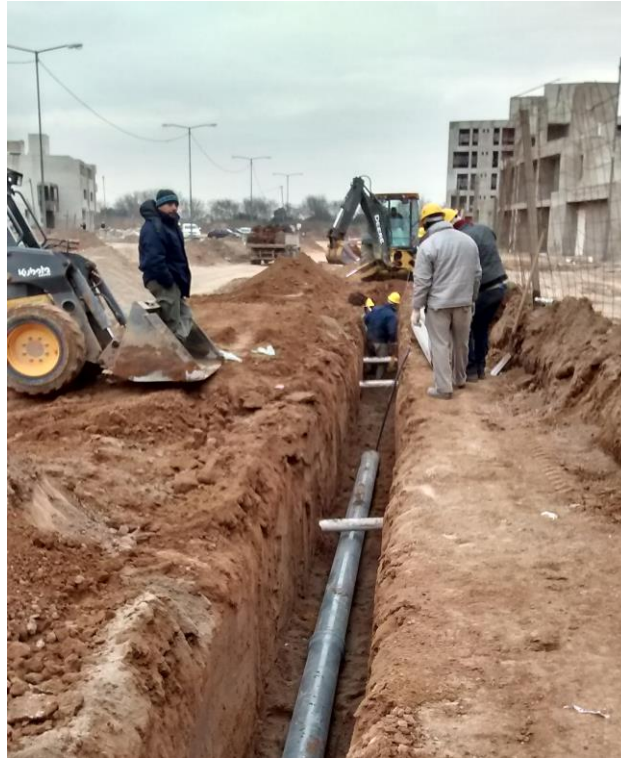
Figura 5.6 - Apertura, tendido de fondo de arena y colocación de caños salvando interferencias de las conexiones de la red cloacal.
