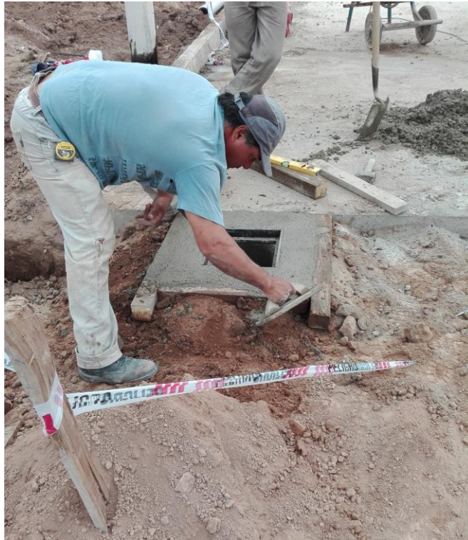
Figura 5.19 - Ejecución de una Cámara de Desagüe ubicada en Calle Pública 11 y C. Oyuela.
