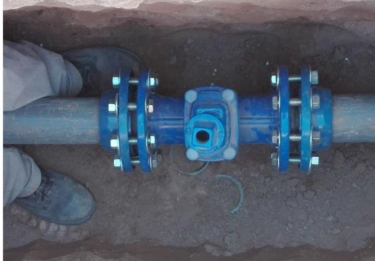
Figura 5.12 - Válvula esclusa conectada con adaptador de bridas a los caños.
