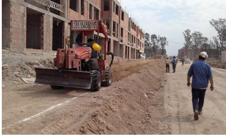
Figura 5.1 - Traza marcada para guiar la excavación en tramo sobre vereda ejecutada con zanjadora.
