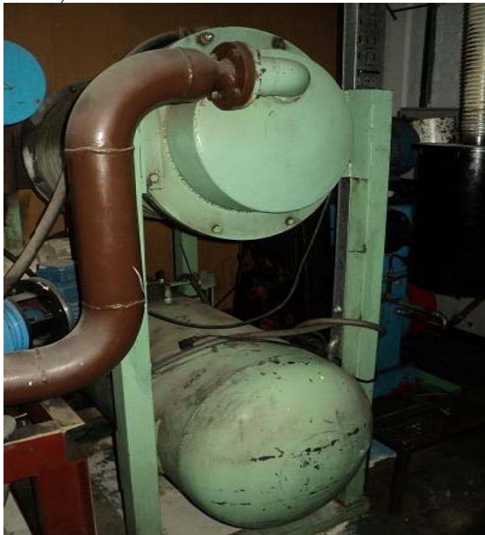
Figura 31: Condensador (parte superior) y tanque receptor del líquido condensado (parte inferior).
