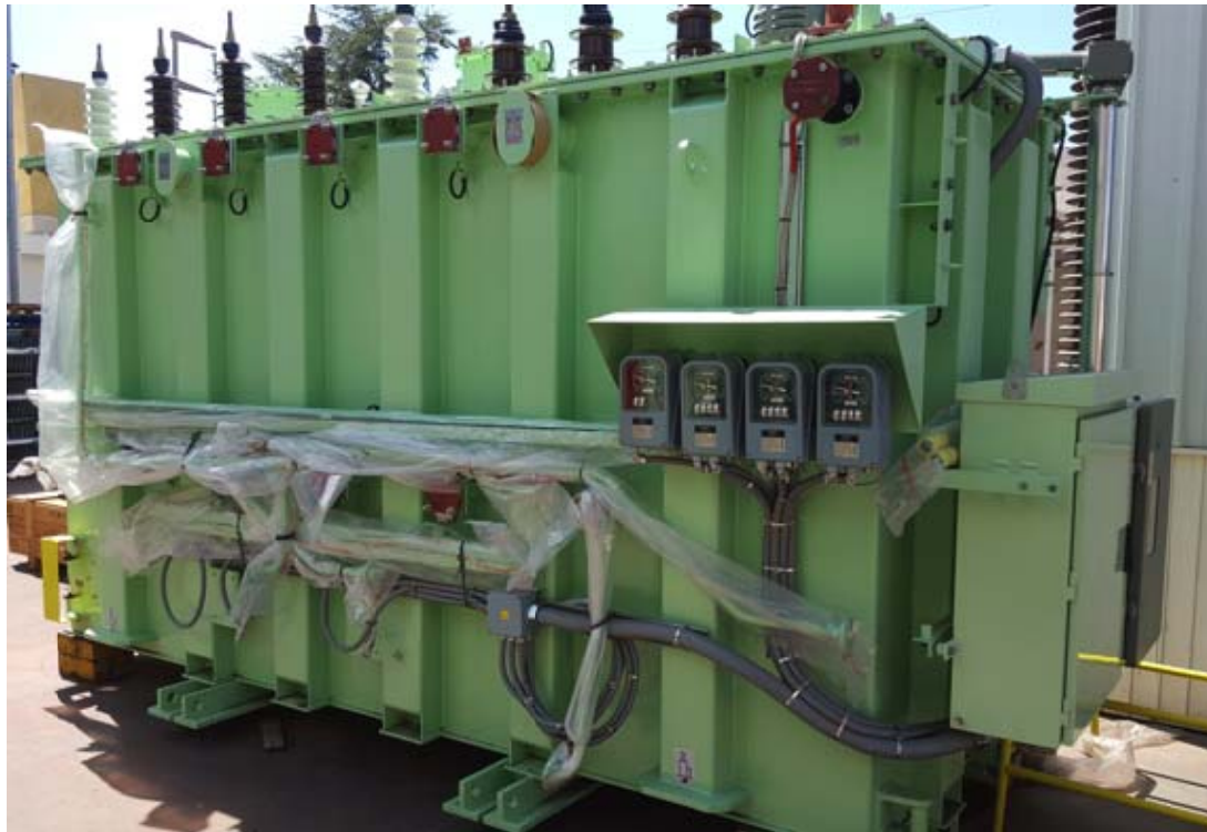
Figura 2: Transformador Tipo de 40 MVA Terminado.
