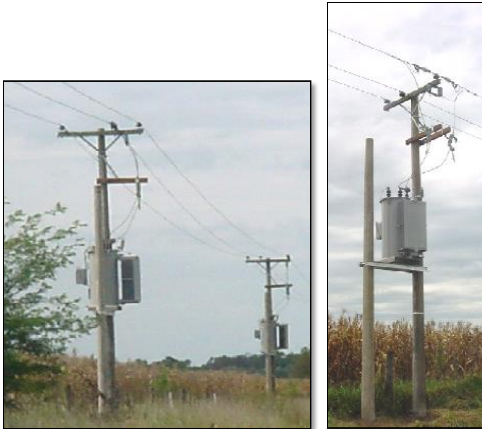
Figura 54. Fotos de reguladores montados en postes de alineación con postecillo
