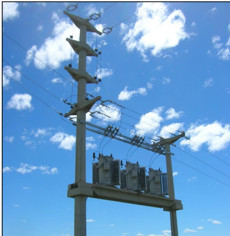
Figura 52. Banco de reguladores instalados sobre plataforma – foto N°1
