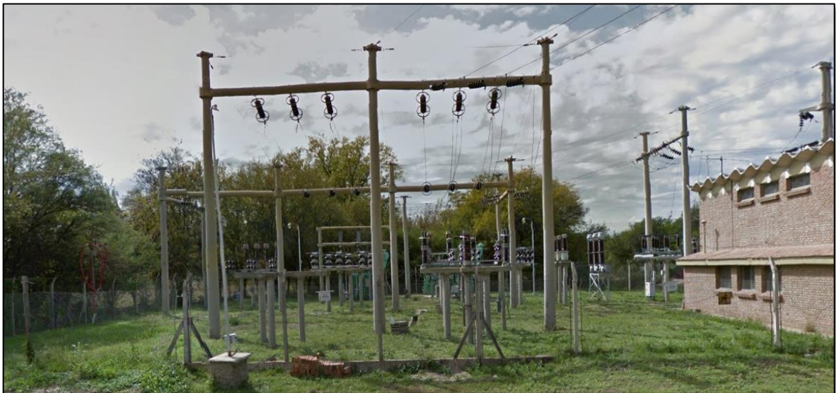
Figura 34. Foto de la Estación Transformadora desde el exterior
