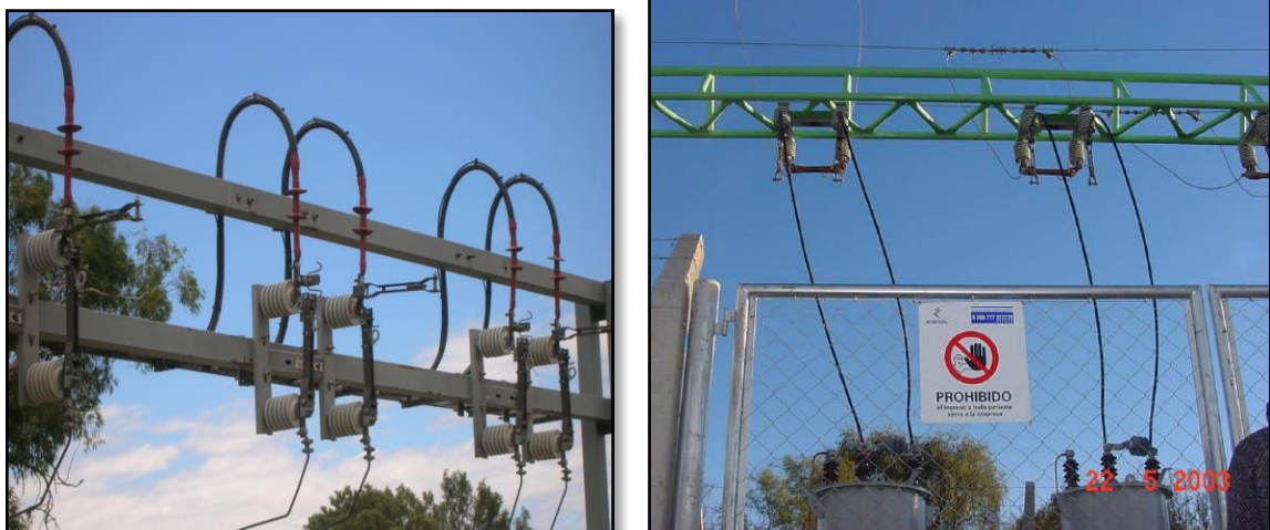
Figura 75. Seccionadores By Pass instalados en un montaje a nivel del banco de reguladores
