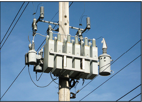
Banco de Capacitores
