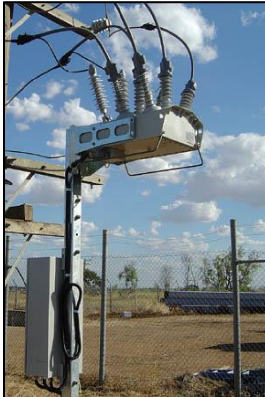
Figura 63. Reconector montado en Estación
