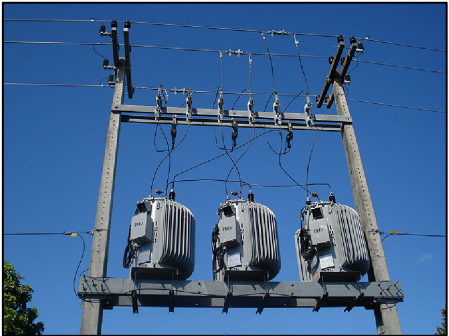
Banco de Reguladores
