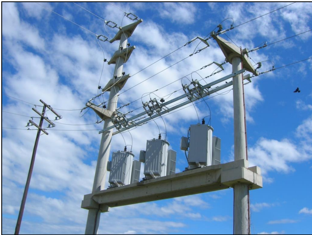
Figura 53. Banco de reguladores instalados sobre plataforma – foto N°2
