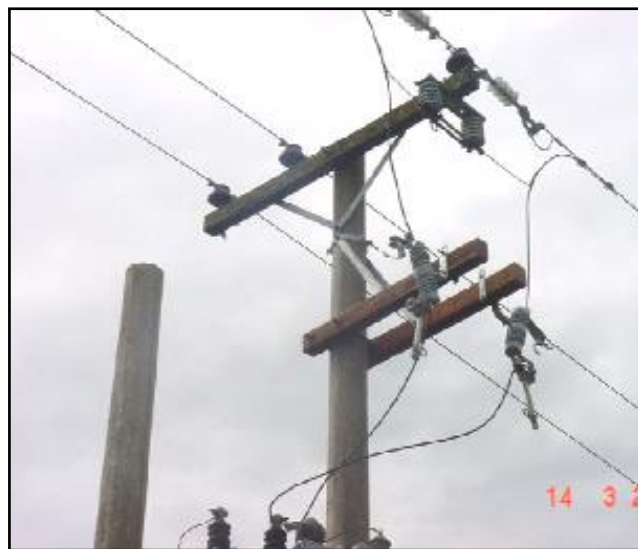
Figura 55. Seccionamiento del regulador mediante seccionadores a cuchillas
