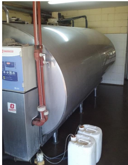
Figura 8: Sala de Leche.
