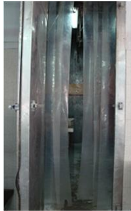
Figura 18: Entrada a cámara frigorífica con cortina.
