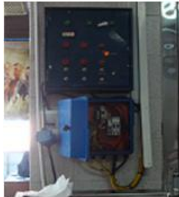
Figura 24. Falta de indicadores en tablero.
