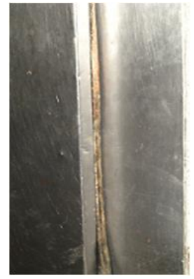
Figura 22: Burlete en mal estado.
