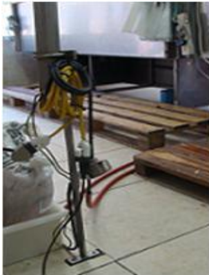
Figura 23. Sistema eléctrico con riesgo.
