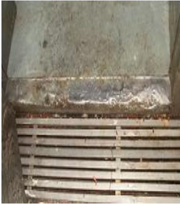
Figura 17: Entrada a cámara frigorífica sucia.
