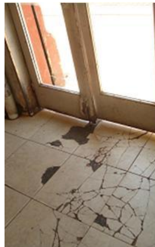
Figura 26: Ingreso dañado por res
