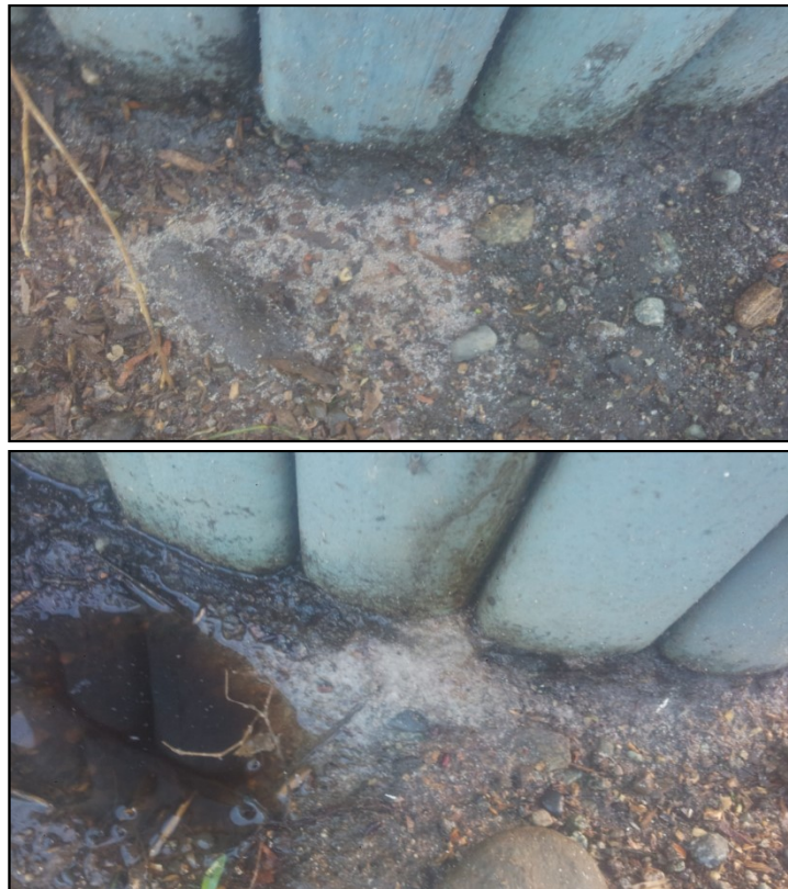
Fig. 4.4. Pérdidas del sistema de recolección de líquidos lixiviados observadas durante el desarrollo del proceso de compostaje.
