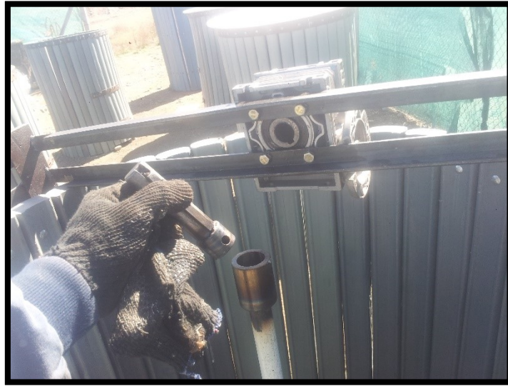
Fig. 2.15. Mejoras aplicadas al sistema de encastre entre el soporte y caja reductora, con los ejes mezcladores de cada compostador.
