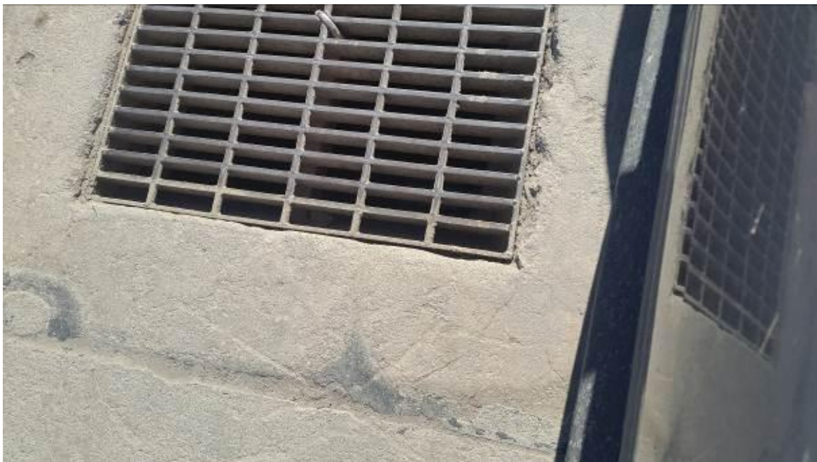
Figura 26: Reja sobre conducto en la misma esquina.
