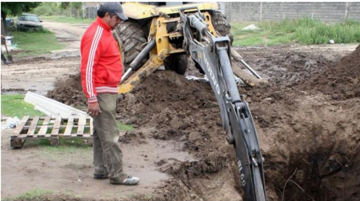
Figura 71: Nueva boca de tormenta en la esquina de D. Ciancia y Deán Funes.
