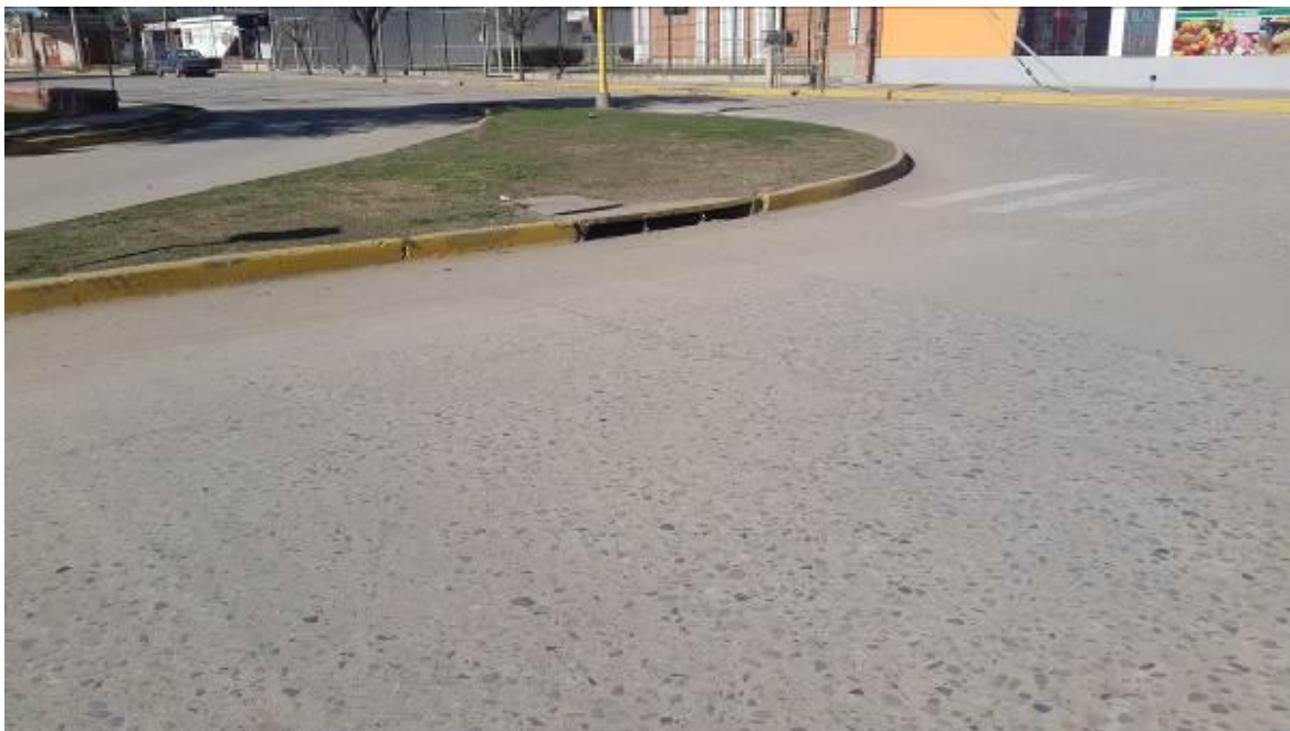
Figura 30: Sumidero Este calle Lavalle y Bv. Dalle Mura.
