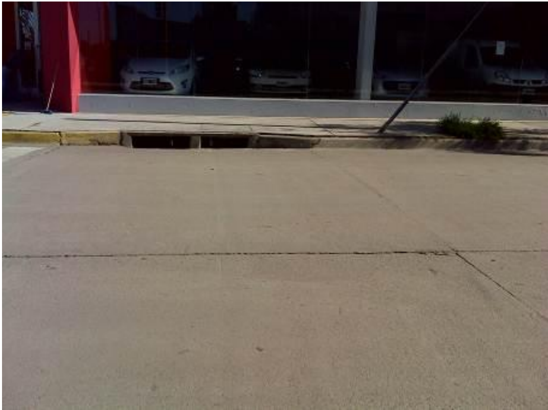
Figura 17: Sumidero San Martín esquina Marcial Vaudagna.
