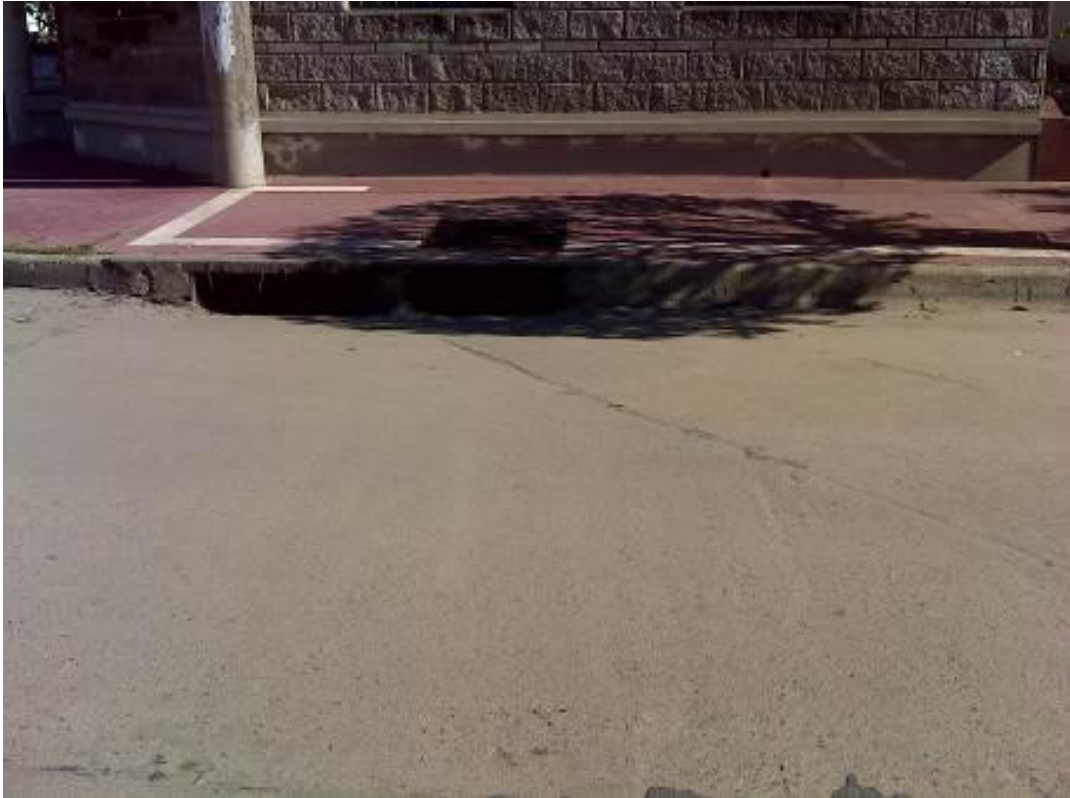
Figura 13: Sumidero sobre San Martín entre Colón y Quijada.
