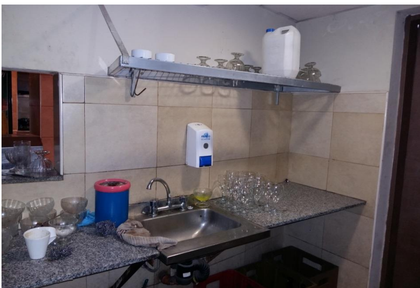
Foto 4. Sector lavaplatos. Detergente almacenado en estantería con vajilla limpia. Dispenser de jabón roto. Rejilla sucia.
