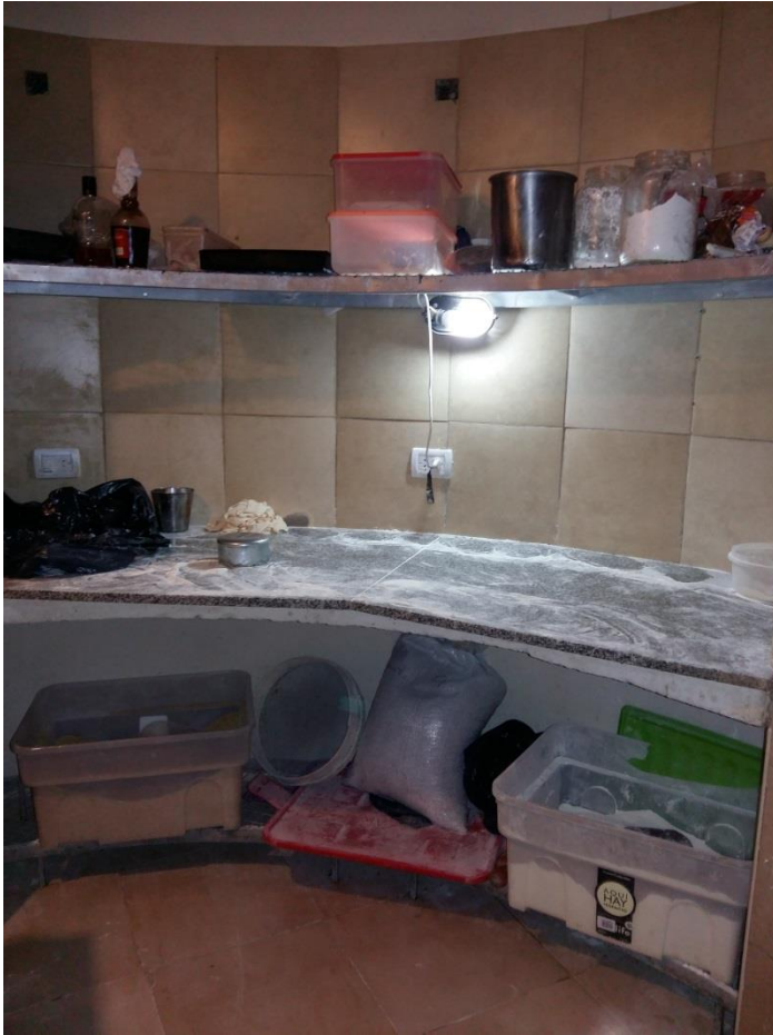
Foto 3. Sector Panadería. Instalación eléctrica inadecuada (sin protección antiestallido/ cinta aisladora/ boca sin tapa ciega). Frascos y botella sin tapa correspondiente.
