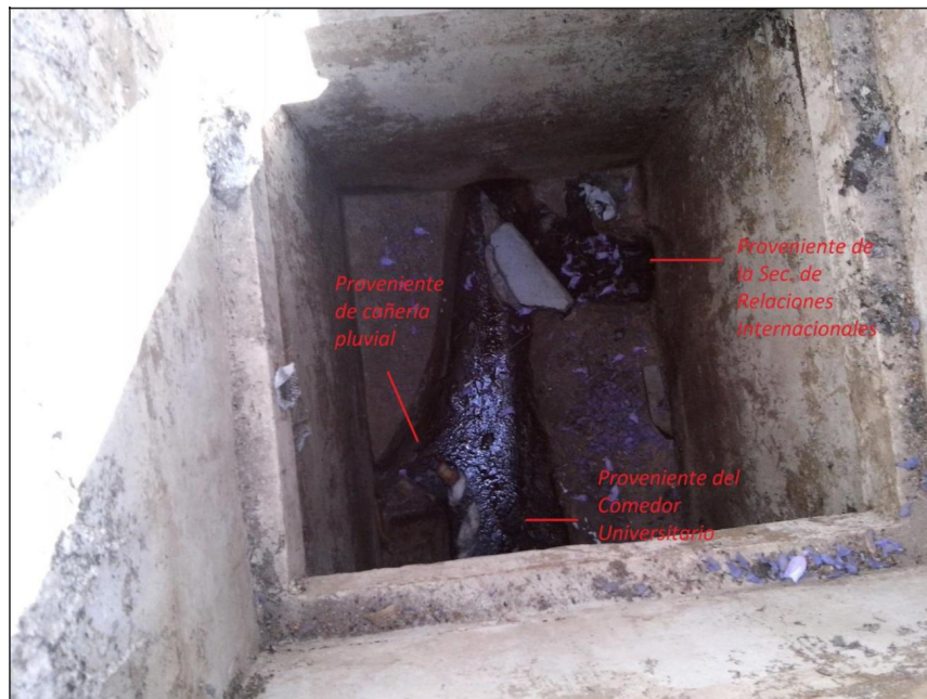
Figura 5.19 - Cámara de inspección N°1
