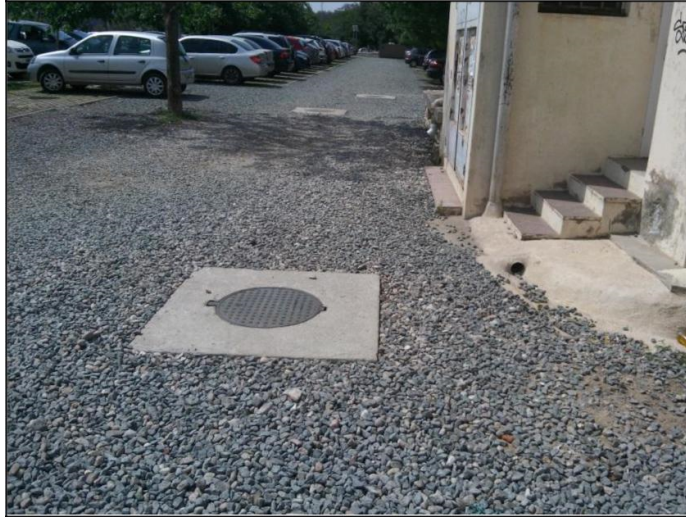
Figura 5.25 - Tapa de la boca de registro N°4.
