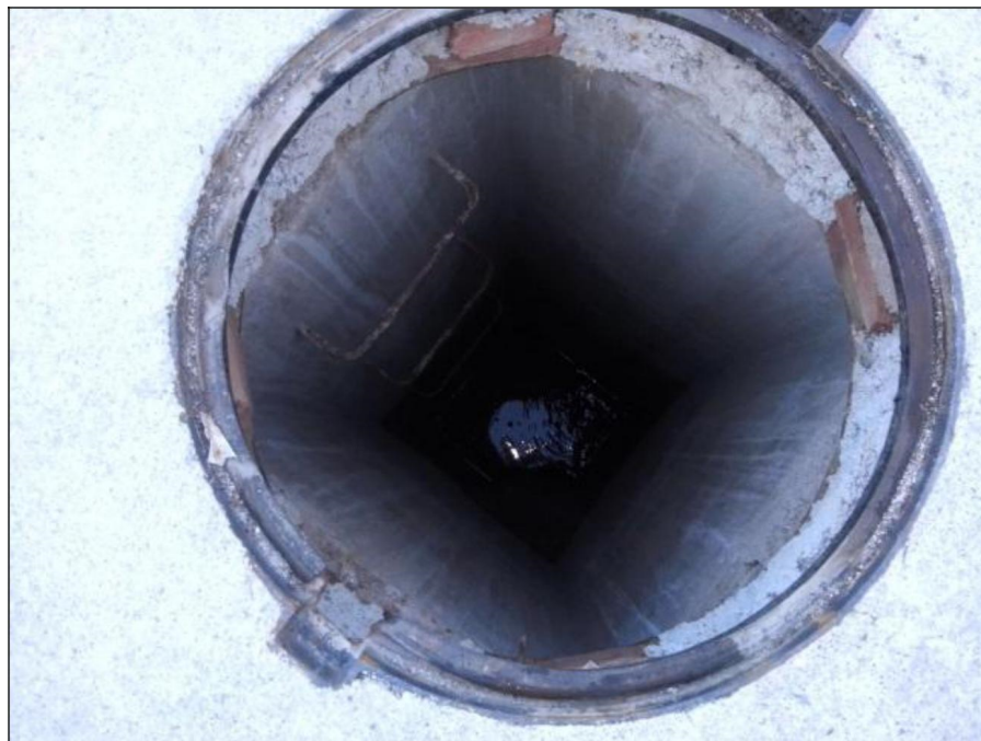
Figura 5.13 - Boca de registro N°3 (Plano N°2 – Anexo A) de la red cloacal, con acumulación de líquidos
