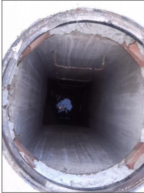
Figura 5.23 - Boca de registro N°3, con acumulación de líquidos
