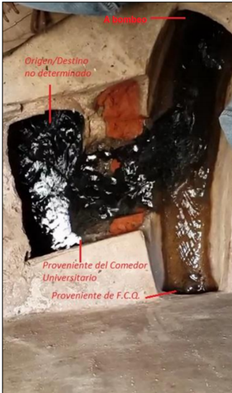
Figura 5.22 - Boca de registro N°3
