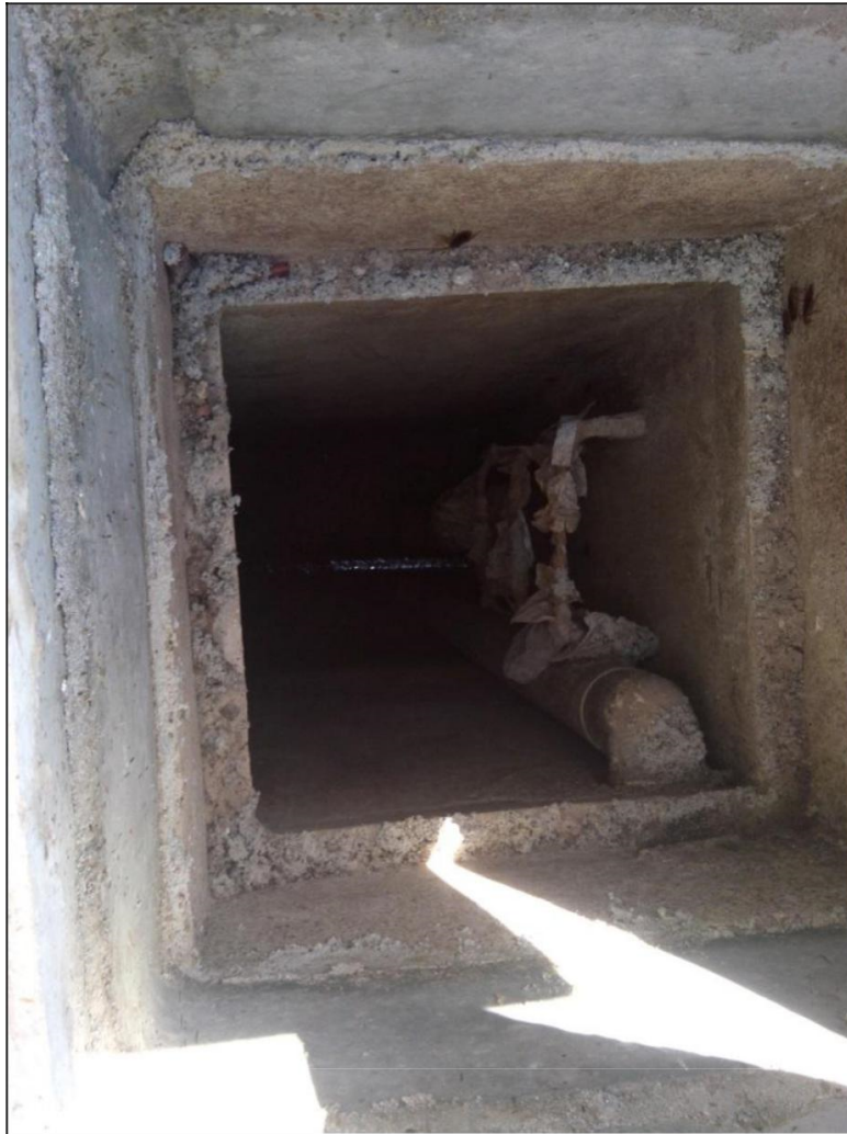
Figura 5.20 - Boca de registro N°2
