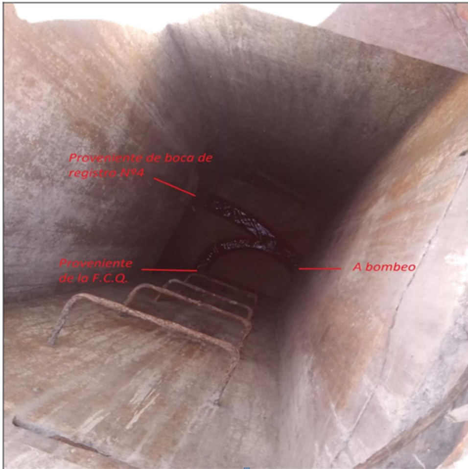
Figura 5.26 - Boca de registro N°5.
