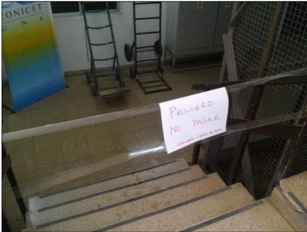
Figura 5.12 - Subsuelo de F.C.Q., inundado por colapso cloacal
