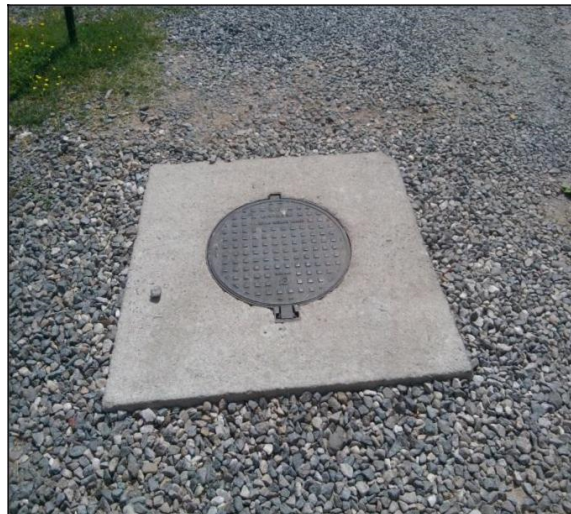
Figura 5.24 - Tapa de la boca de registro N°3
