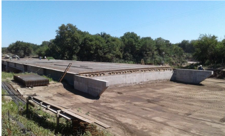
Ilustración 10: Cancha preparada para control
