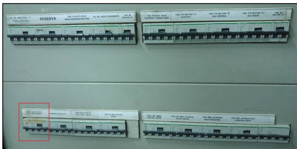
ILUSTRACIÓN 58. TABLERO PRINCIPAL. EN ROJO SE SEÑALA LA LLAVE TERMOMAGNÉTICA CORRESPONDIENTE A LA SALA DE AIRE COMPRIMIDO Y DE VACÍO.
