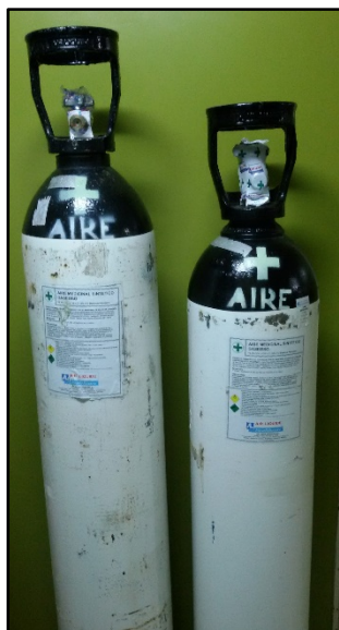
ILUSTRACIÓN 63. CILINDROS DE AIRE MEDICINAL EN QUIRÓFANO
