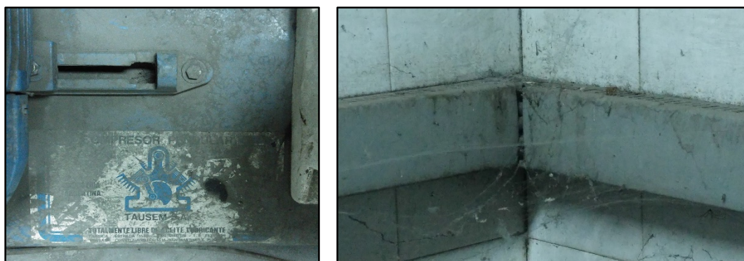
ILUSTRACIÓN 45. SUCIEDAD EN LA ETIQUETA DEL COMPRESOR Y EN LAS PAREDES PRÓXIMAS AL COMPRESOR
