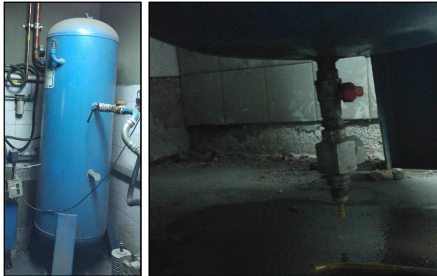
ILUSTRACIÓN 49. TANQUE DE RESERVA Y VÁLVULA DE DRENAJE MANUAL
