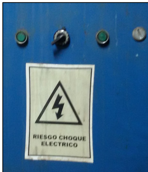
ILUSTRACIÓN 65. TAPA FRONTAL DEL TABLERO SECCIONAL
