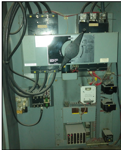
ILUSTRACIÓN 56. TABLERO DE CONMUTACIÓN
