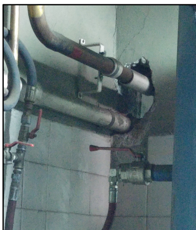
ILUSTRACIÓN 46. COMUNICACIÓN ENTRE LA SALA DE AIRE COMPRIMIDO Y LA SALA DE VACÍO
