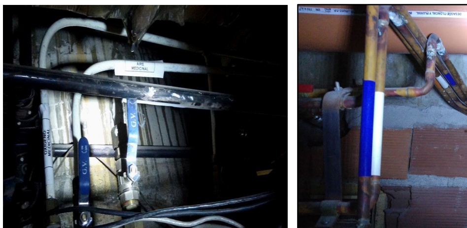
ILUSTRACIÓN 62. SEÑALIZACIÓN ERRÓNEA DE LAS CAÑERÍAS DE LA RED DE DISTRIBUCIÓN
