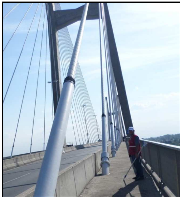
Figura 4.3. Puente Principal-Inspección Visual de obenques y juntas de dilatación
