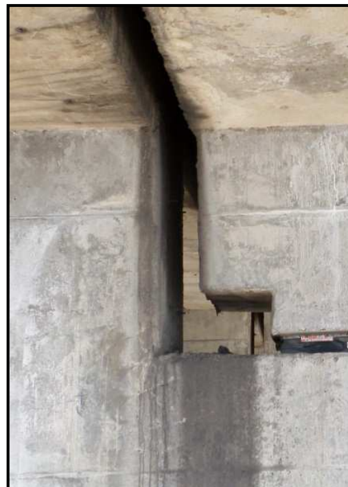
Figura 6.21. Mancha por falta de estanqueidad de junta de dilatación N° 9- Aguas Arriba- Viaducto de Acceso Este
