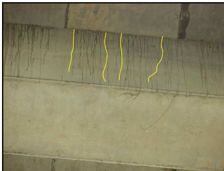
Figura 6.14. Panorama fisurativo en viga entre ejes de pilas 45 y 46-Aguas arriba-Viaducto de Acceso Oeste
