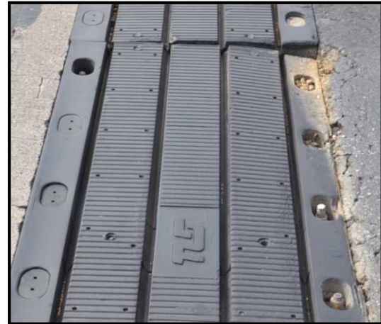
Figura 6.25. Leve hundimiento en junta de dilatación N°1 (estribo oeste)-Puente en Zona de Islas (La Camiseta 1)
