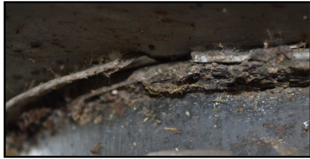
Figura 6.29. Desplazamiento y corte de teflón (PTFE)-Apoyo estribo oeste (aguas arriba)-Puente Paranacito Victoria
