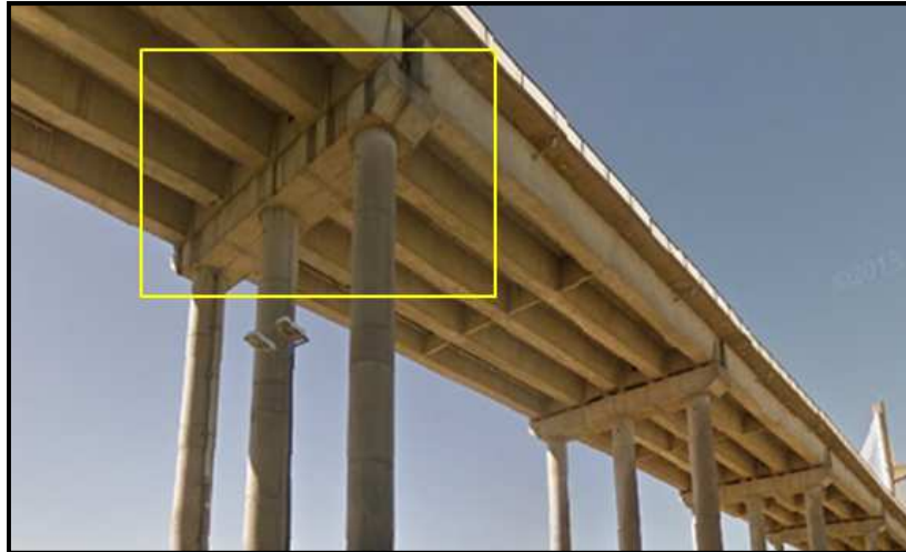
Figura 6.22. Manchas por escurrimiento de agua en viga cabecera encuadrada en amarillo-Viaducto de Acceso Oeste
