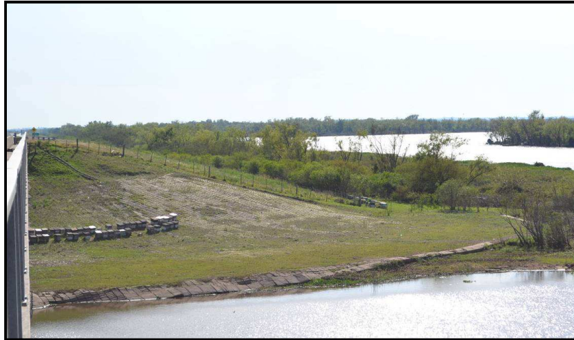
Figura 6.33. Asentamiento localizado de la protección del estribo Este-Puente Camiseta 1
