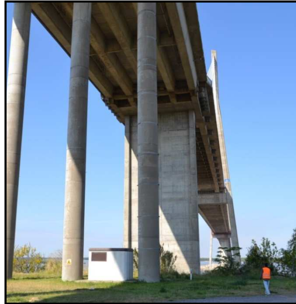
Figura 4.2. Viaducto de Acceso Oeste-Inspección Visual de las superficies de superestructura y pilotes
