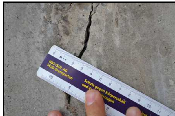
Figura 6.1. Fisura en Junta Constructiva por defectos en su ejecución
