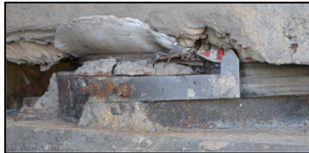
Figura 6.30. Desplazamiento de teflón (PTFE)-Apoyo estribo oeste (aguas abajo)-Puente Zanja la Zorra
