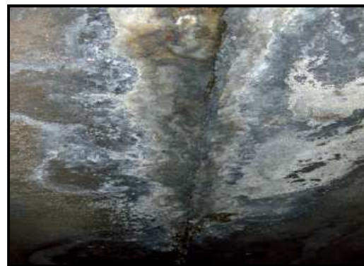
Figura 6.6. Manifestación de efluencia en tablero de un puente. Imagen en Ref. [5]
