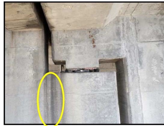
Figura 6.11. Esgurrimiento en junta Gerber N° 7- Aguas arriba-Viaducto de Acceso Este
