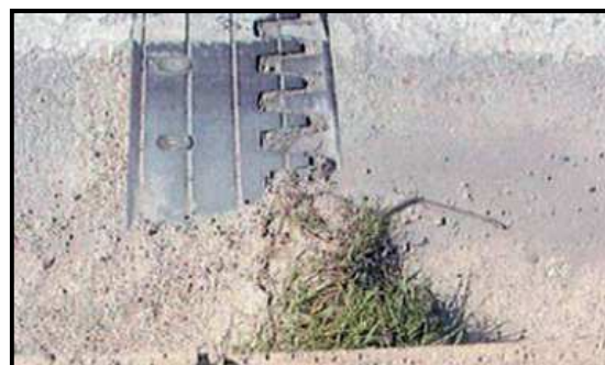
Figura 6.18. Acumulación de material en junta tipo peine. Imagen en Ref. [5]
