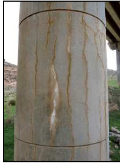
Figura 6.5. Manifestación de fisuras por corrosión de armaduras en pila. Imagen en Ref. [5]
