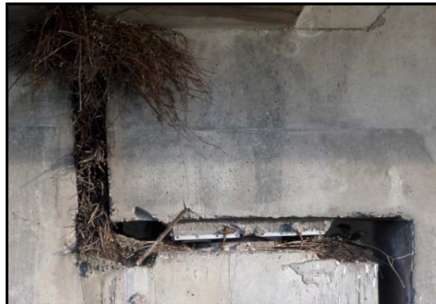
Figura 6.16. Nidos en junta Gerber N° 2-Aguas arriba-Puente Paranacito Victoria
