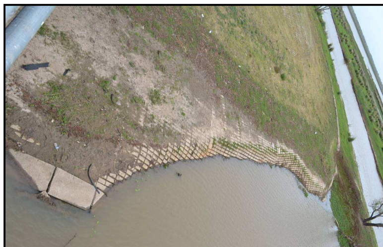
Figura 6.32. Asentamiento localizado de la protección del estribo Oeste-Puente Banderas
