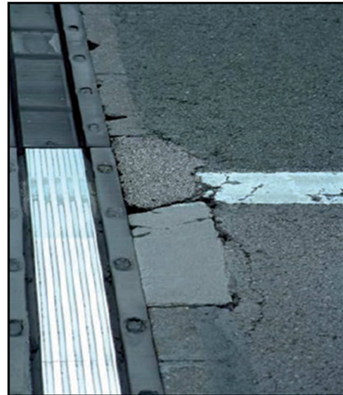
Figura 6.19. Manifestación de fisuras y pérdida de material de borde en una junta. Imagen en Ref. [5]
