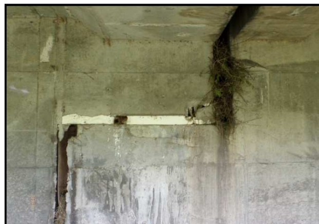
Figura 6.31. Presencia de nidos y telgopor-Apoyo N° 16 (Aguas abajo)-Viaducto de Acceso Este
