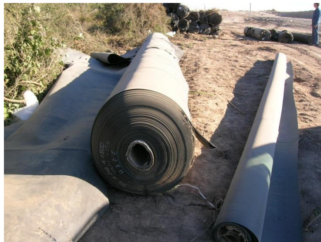
Figura N° 3.2 : Geomembrana utilizada en el fondo de la celda.
