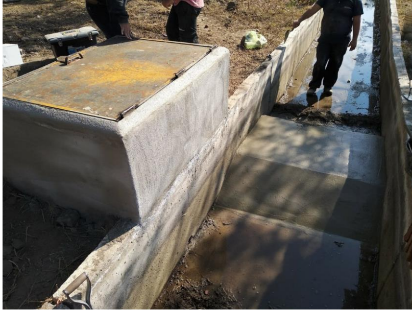
Imagen 15: Aforador y cámara sobre Canal Maestro Soto – Proveduría
