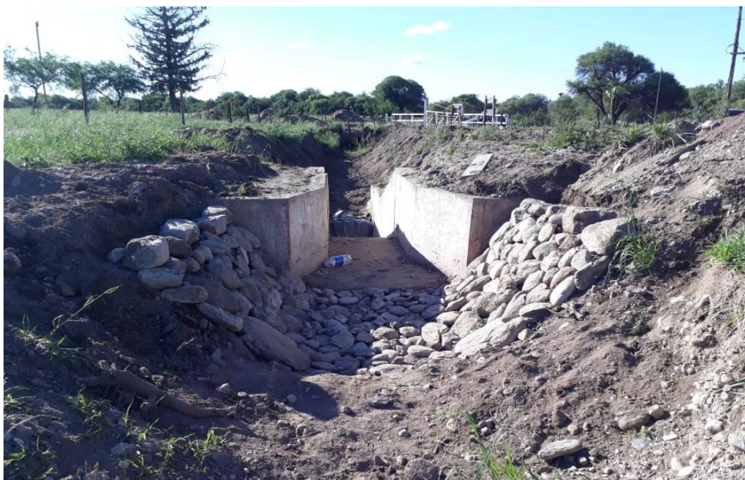
Imagen 13: Salto con cuenco disipador - Canal Maestro Soto
